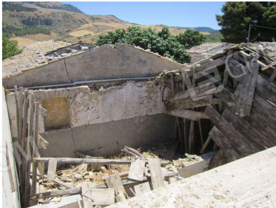
Allegato 5.16: vano distrutto
