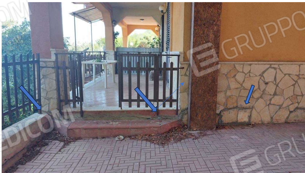
Foto corte esterna pavimentata con evidenti lesioni da cedimenti
