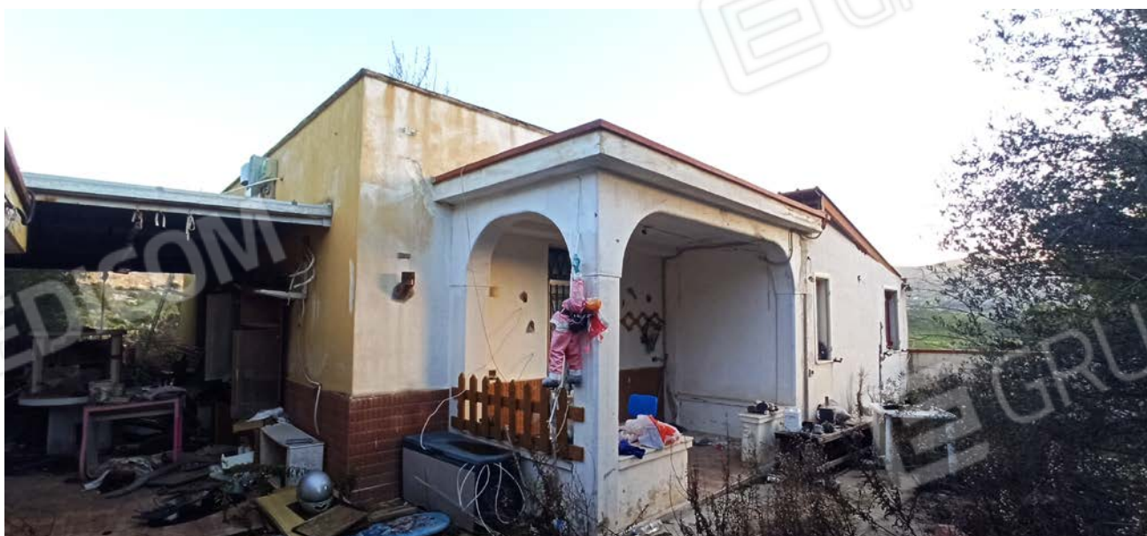
Foto n.5 – Visuale zona prospetto d'ingresso con ampliamento abusivo del fabbricato e tettoia
