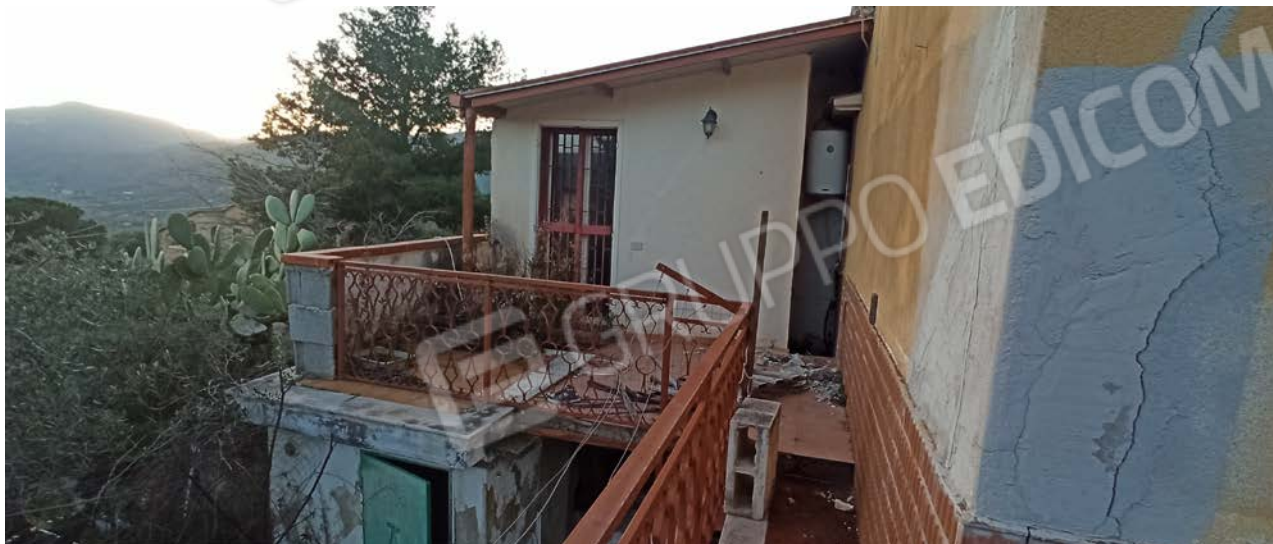
Foto n.6 – Visuale ampliamento abusiv del fabbricato
