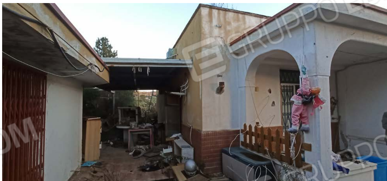
Foto n.7 – Visuale laterale fabbricato con tettoia abusiva
