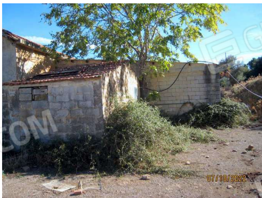
Foto n. 93. Casetta parzialmente abusiva.
