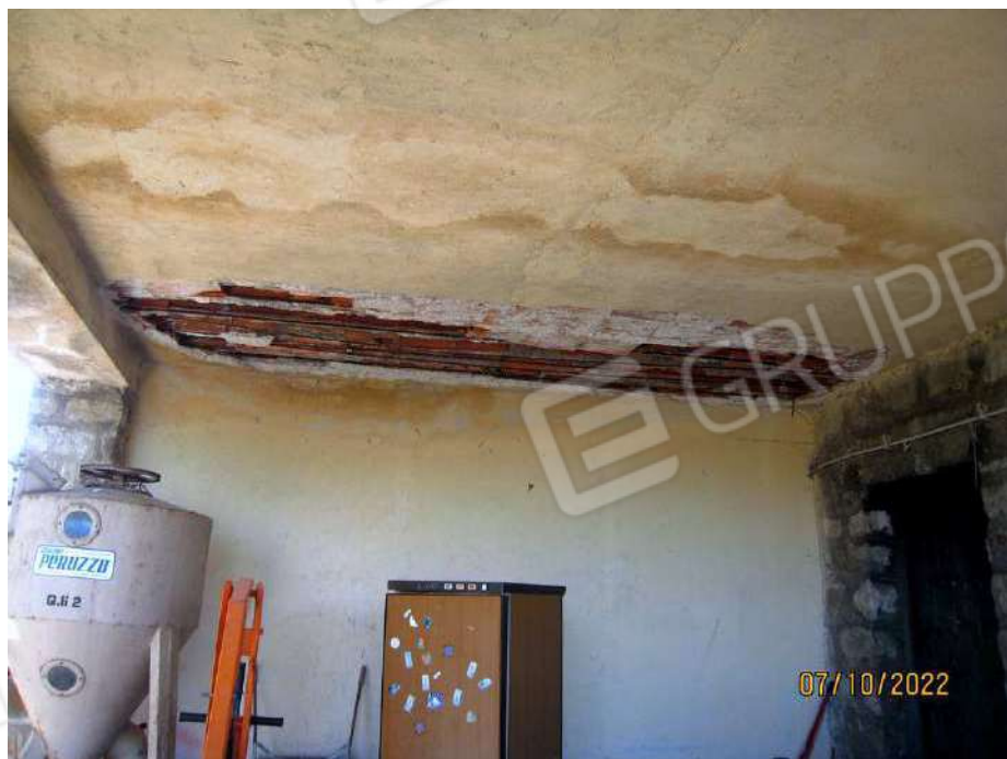
Foto n. 103. Le condizioni del solaio sotto il portico sono pessime.
