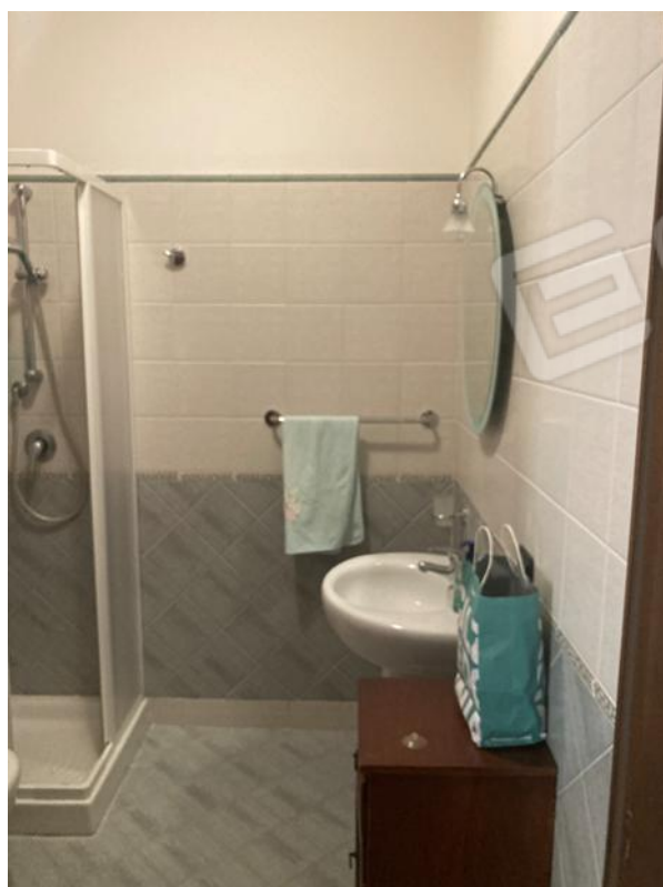
Figura 9. Vista di locale wc realizzato al piano cantinato in assenza di autorizzazione edilizia, foto 1
