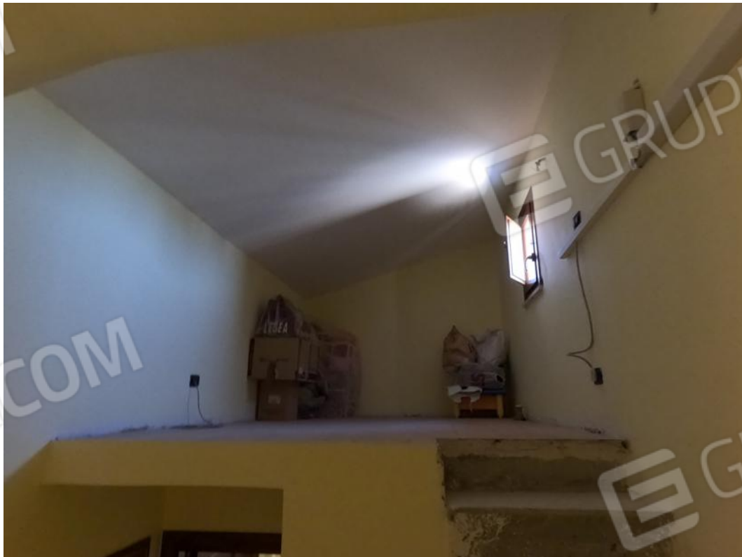
Figura 38. Particolare di soppalco con soletta in c.a. realizzato in difformità rispetto al progetto
