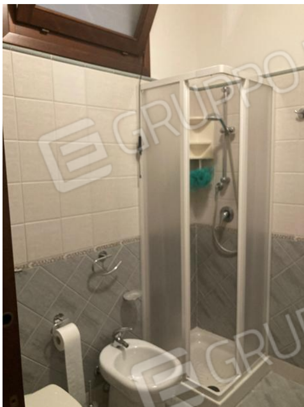
Figura 10. Vista di locale wc realizzato al piano cantinato in assenza di autorizzazione edilizia, foto 2
