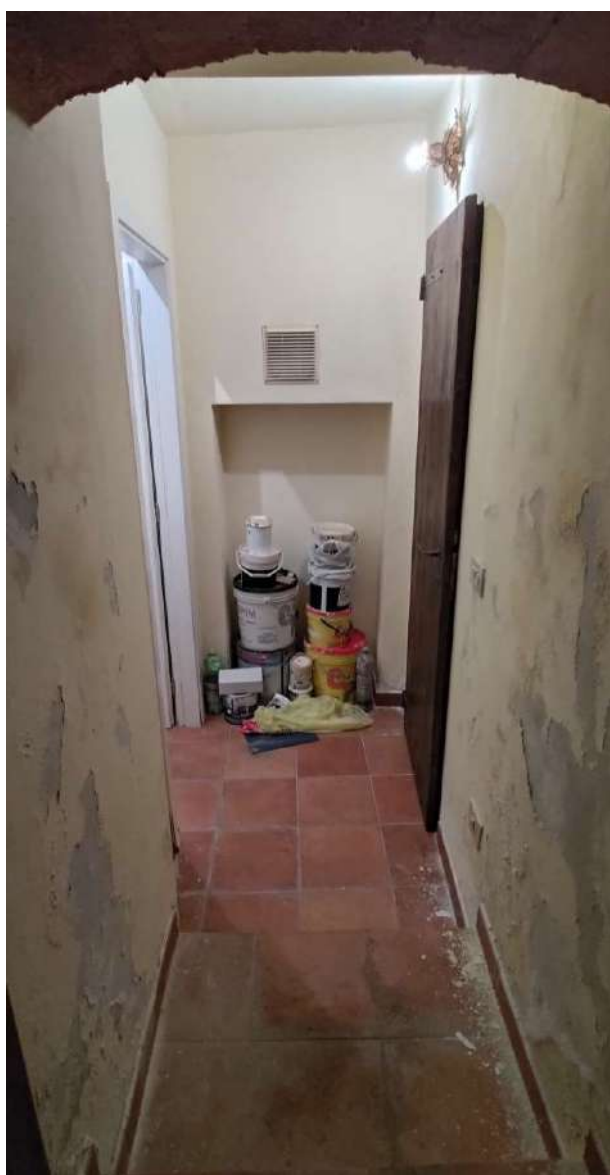
Foto 10 – disimpegno particolare umidità di risalita
