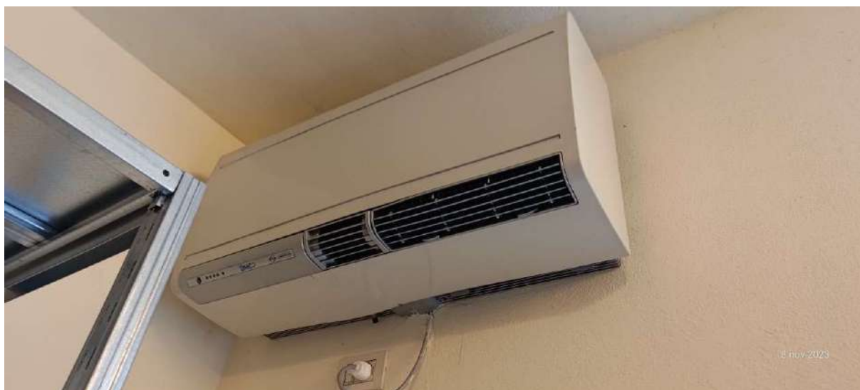
Foto 9 – particolare ventilconvettore a parete
