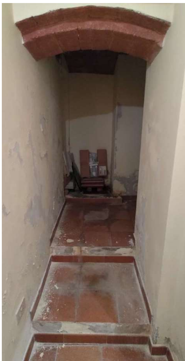
Foto 11 disimpegno particolare umidità di risalita
