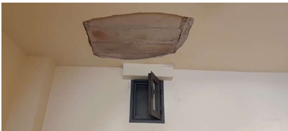
Foto 8 – particolare rovina intonaco solaio
