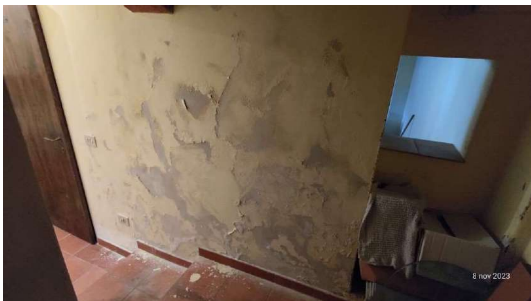
Foto 16 - particolare disimpegno stato conservazione muro
