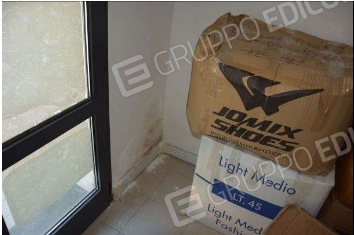
FOTO 13 – infiltrazione di umidità proveniente dalla terrazza
