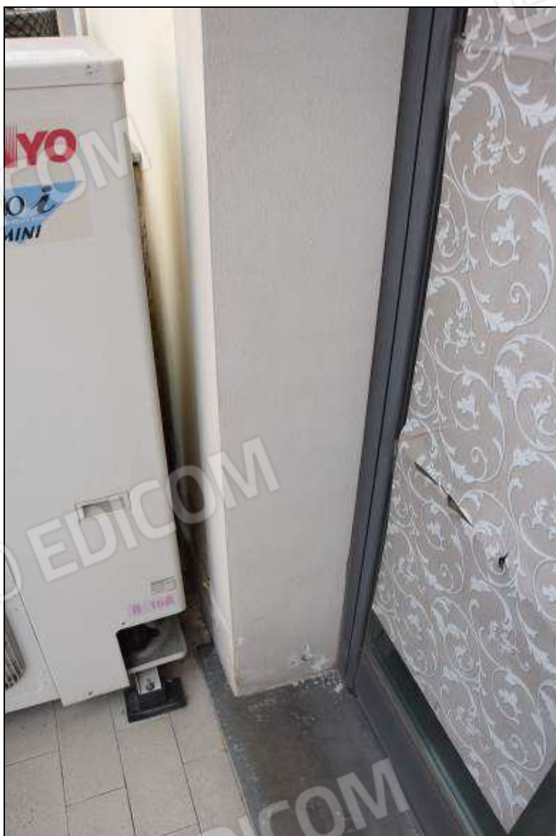
FOTO 11 – infiltrazione di umidità
