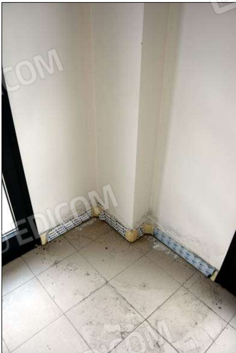
FOTO 11 – infiltrazioni di umidità
