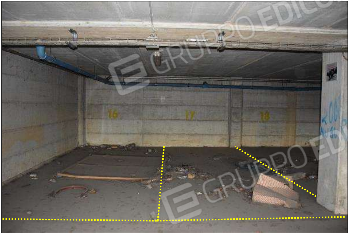
FOTO 1 – SUB 37 (POSTO 16) / SUB 38 (POSTO 17)
