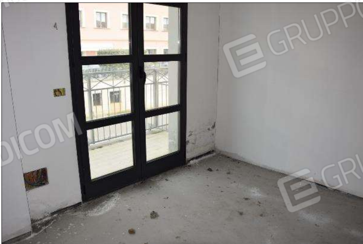
FOTO 90 – particolare - infiltrazioni d'acqua dalla terrazza
