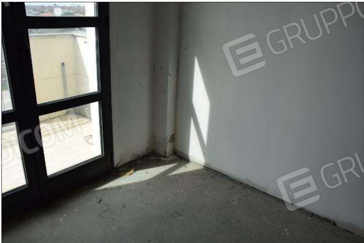
FOTO 38 – particolare - infiltrazioni d'acqua dalla terrazza
