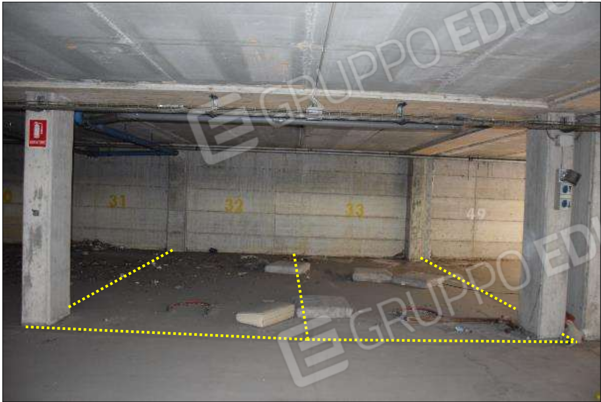
FOTO 9 – SUB 53 (POSTO 32) / SUB 54 (POSTO 33)
