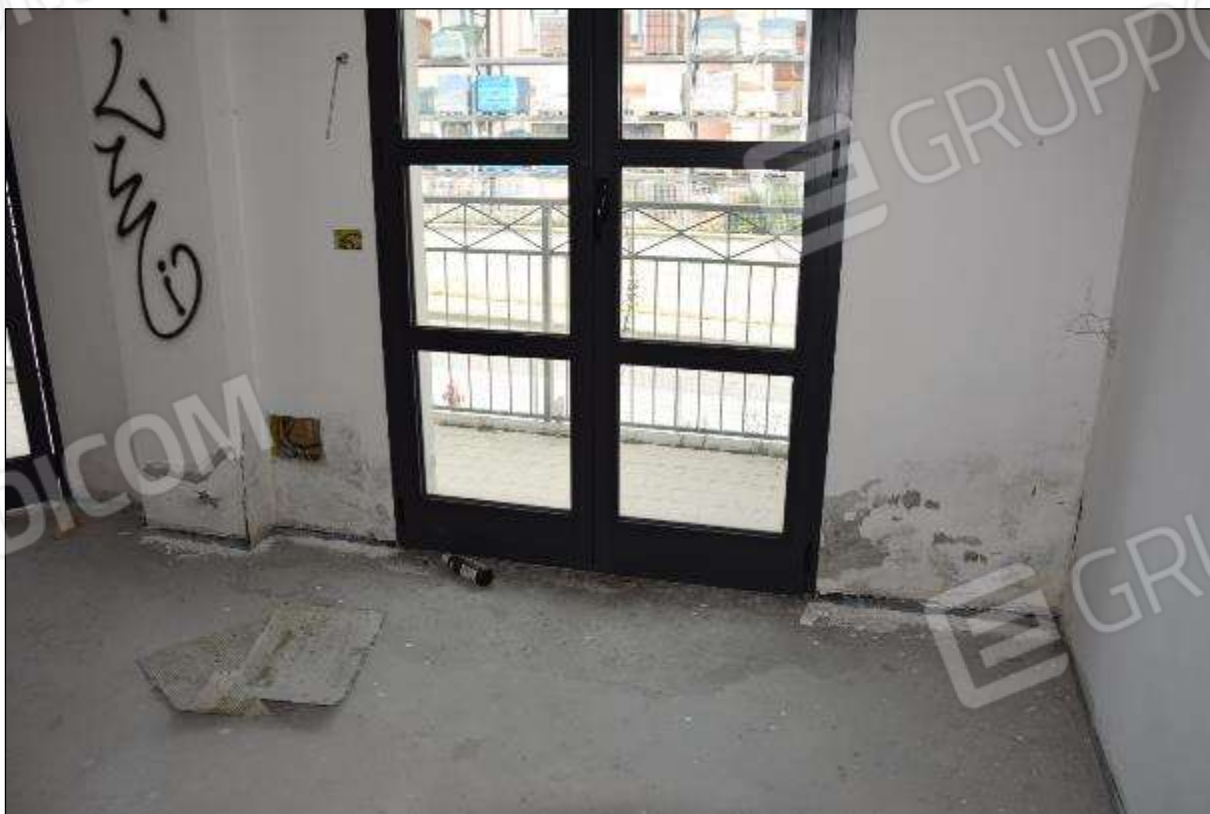
FOTO 72 – particolare - infiltrazioni d'acqua dalla terrazza
