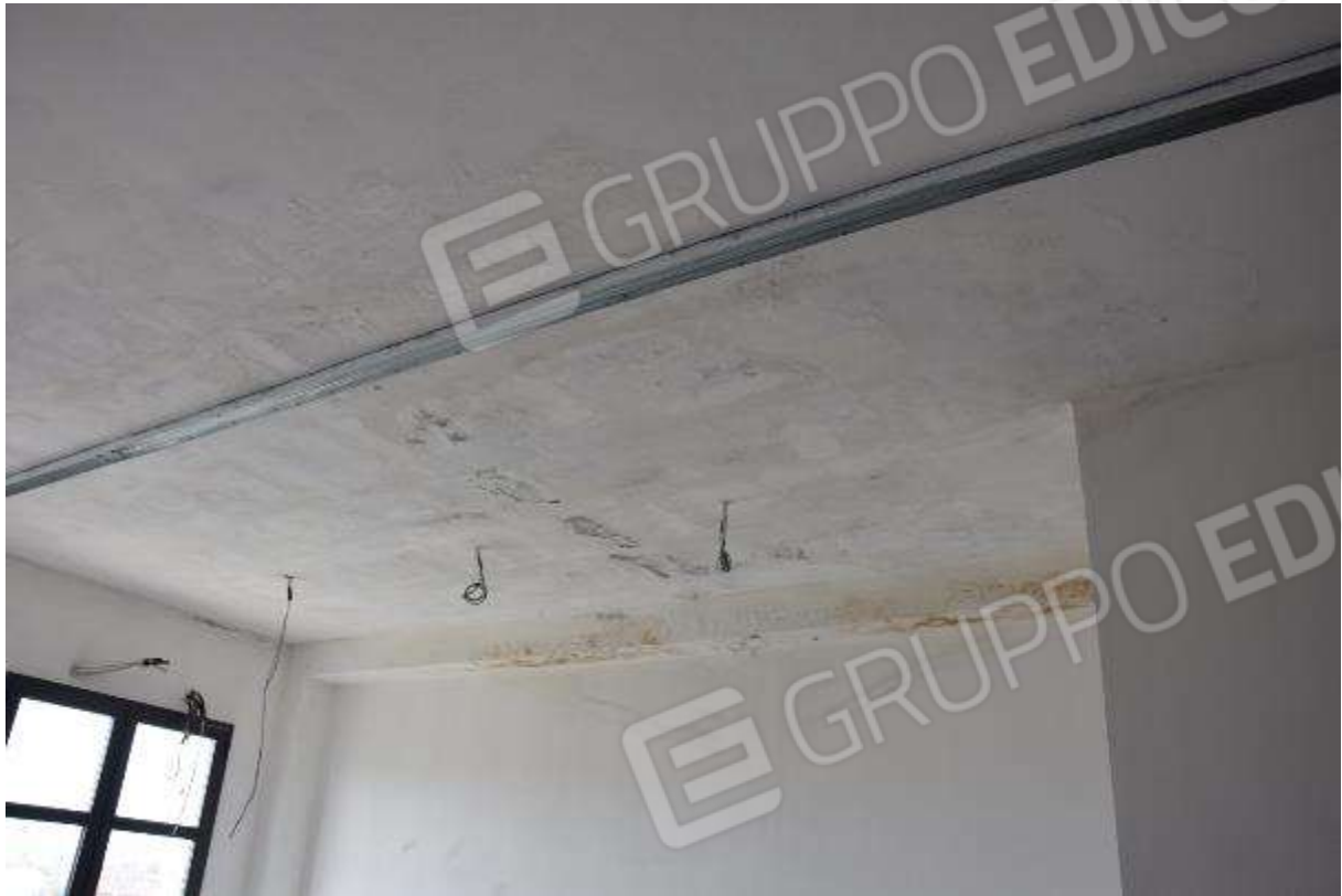
FOTO 32 – particolare - infiltrazioni d'acqua dal piano sottotetto
