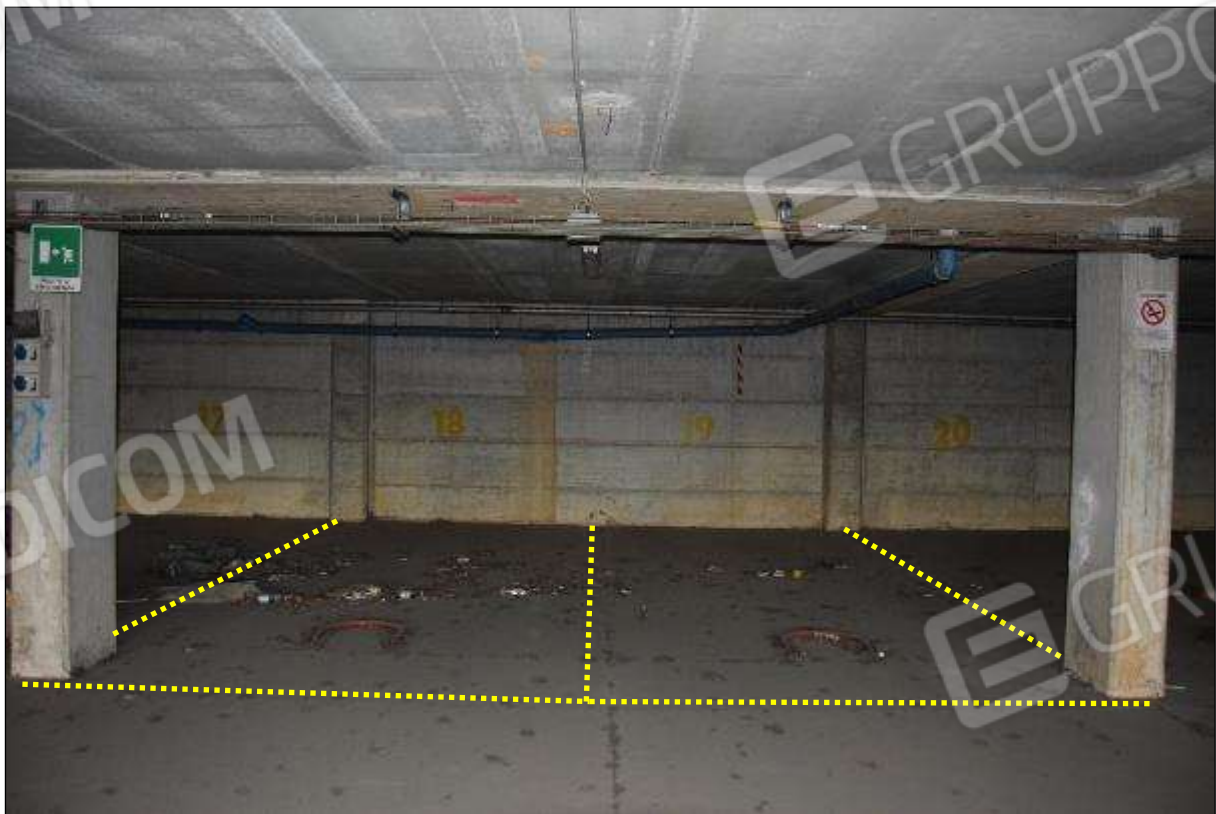
FOTO 2 – SUB 39 (POSTO 18) / SUB 40 (POSTO 19)
