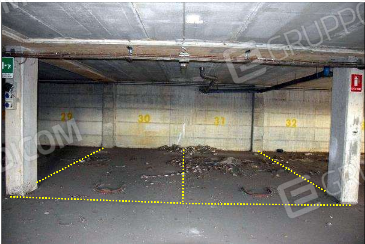
FOTO 8 – SUB 51 (POSTO 30) / SUB 52 (POSTO 31)
