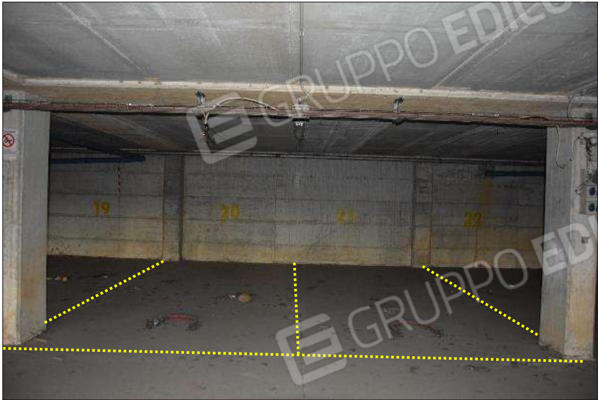
FOTO 3 – SUB 41 (POSTO 20) / SUB 42 (POSTO 21)
