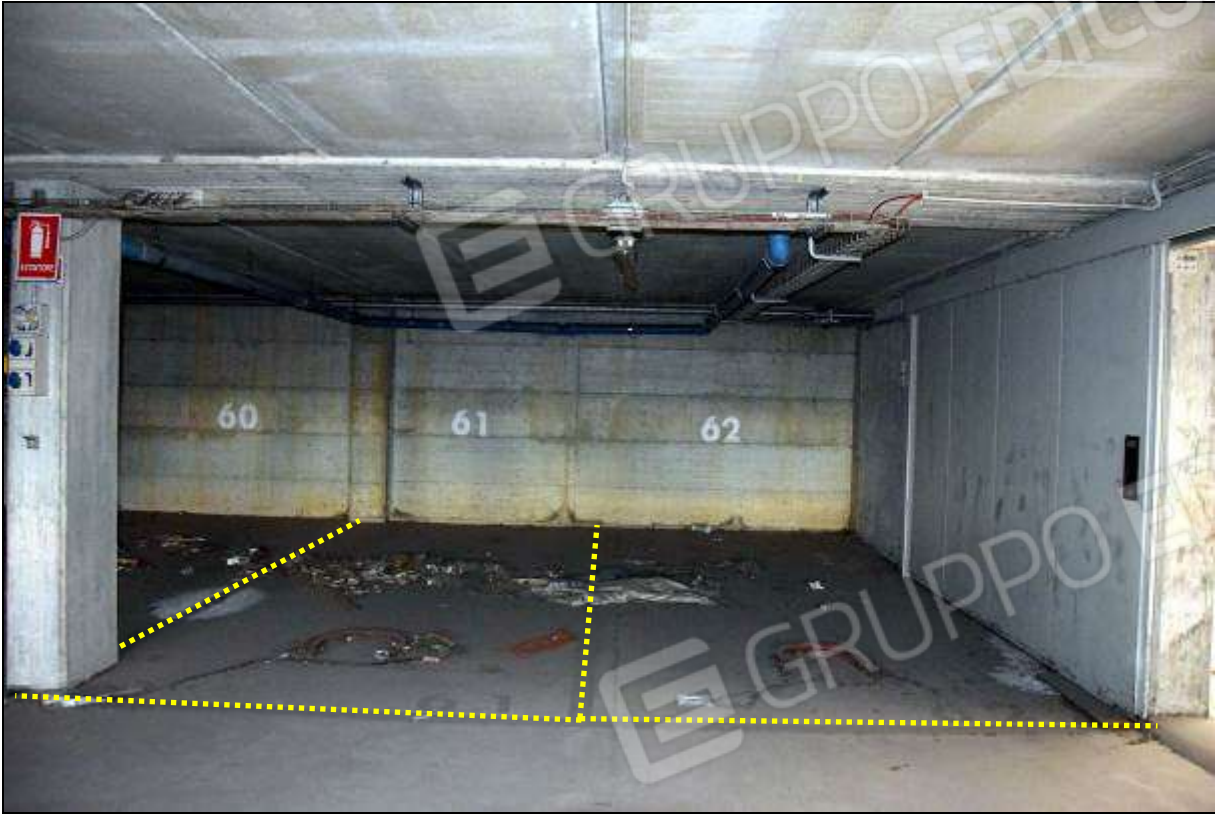
FOTO 1 – SUB 65 (POSTO 61) / SUB 66 (POSTO 62)
