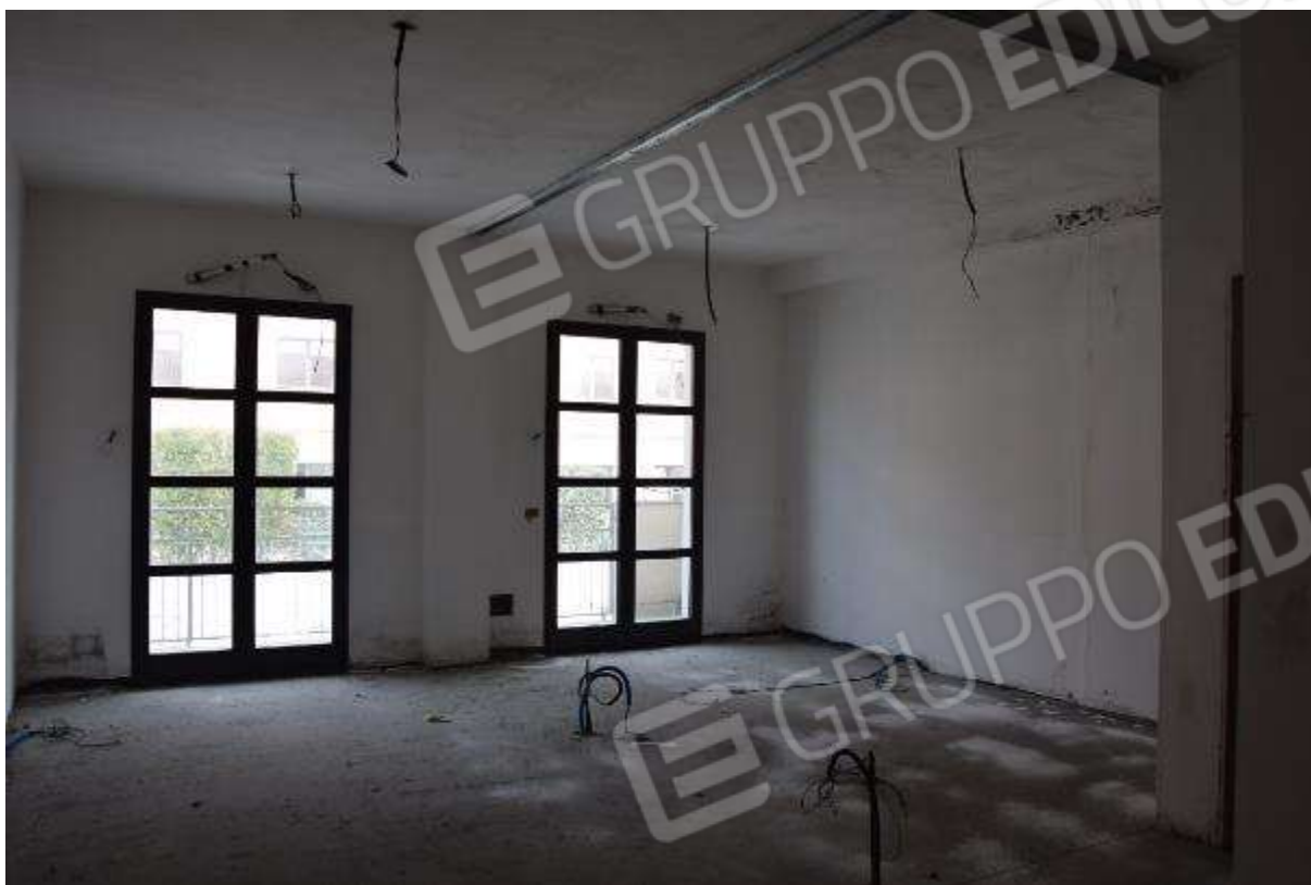
FOTO 98 – particolare - infiltrazioni d'acqua dal piano sottotetto
