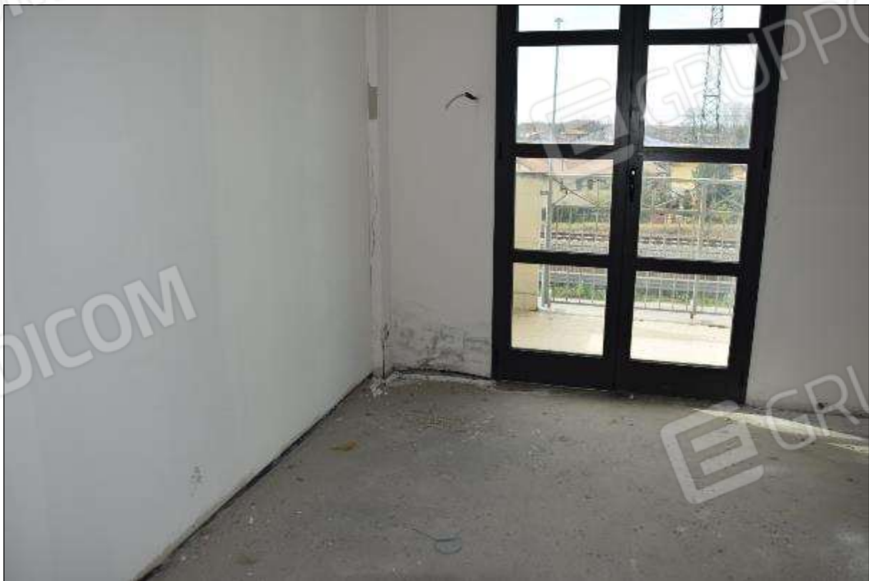
FOTO 31 – particolare - infiltrazioni d'acqua dalla terrazza
