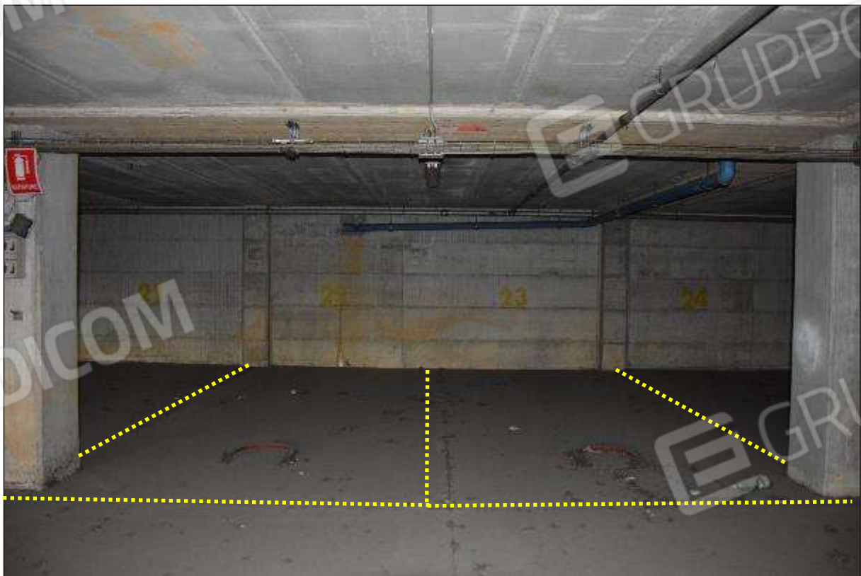
FOTO 4 – SUB 43 (POSTO 22) / SUB 44 (POSTO 23)
