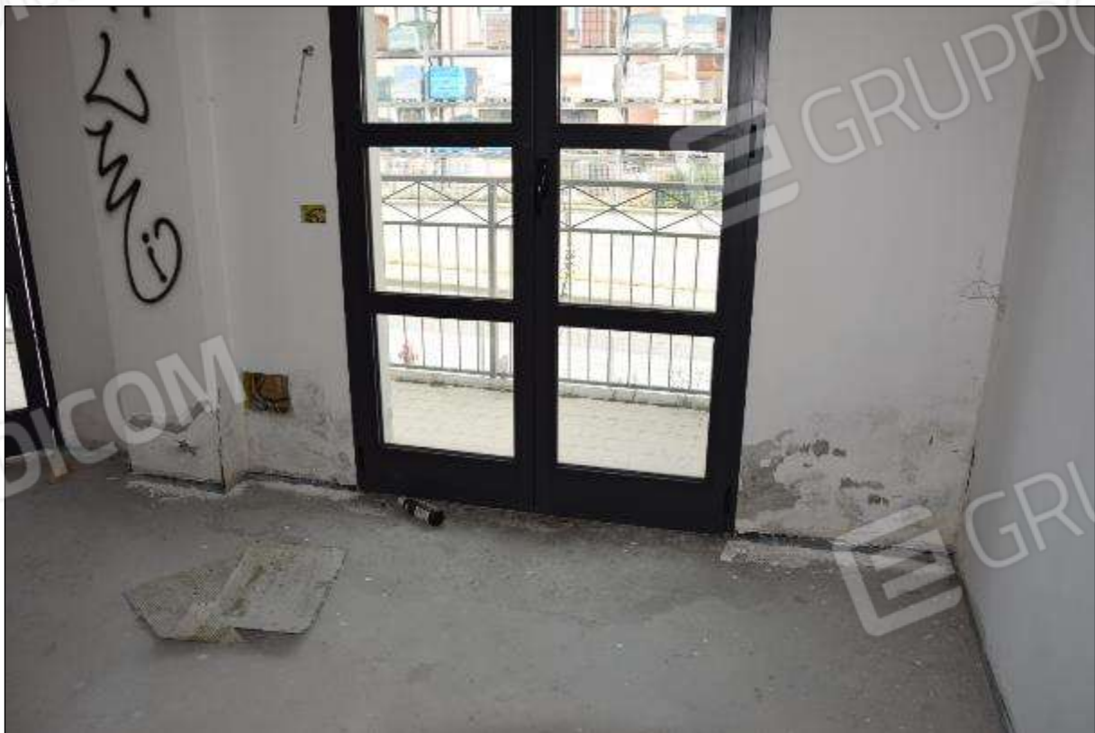
FOTO 72 – particolare - infiltrazioni d'acqua dalla terrazza
