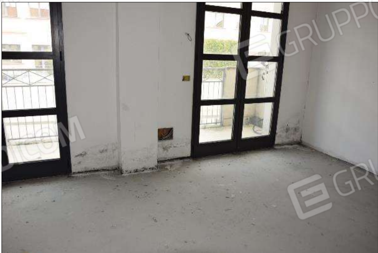
FOTO 84 – particolare - infiltrazioni d'acqua dalla terrazza
