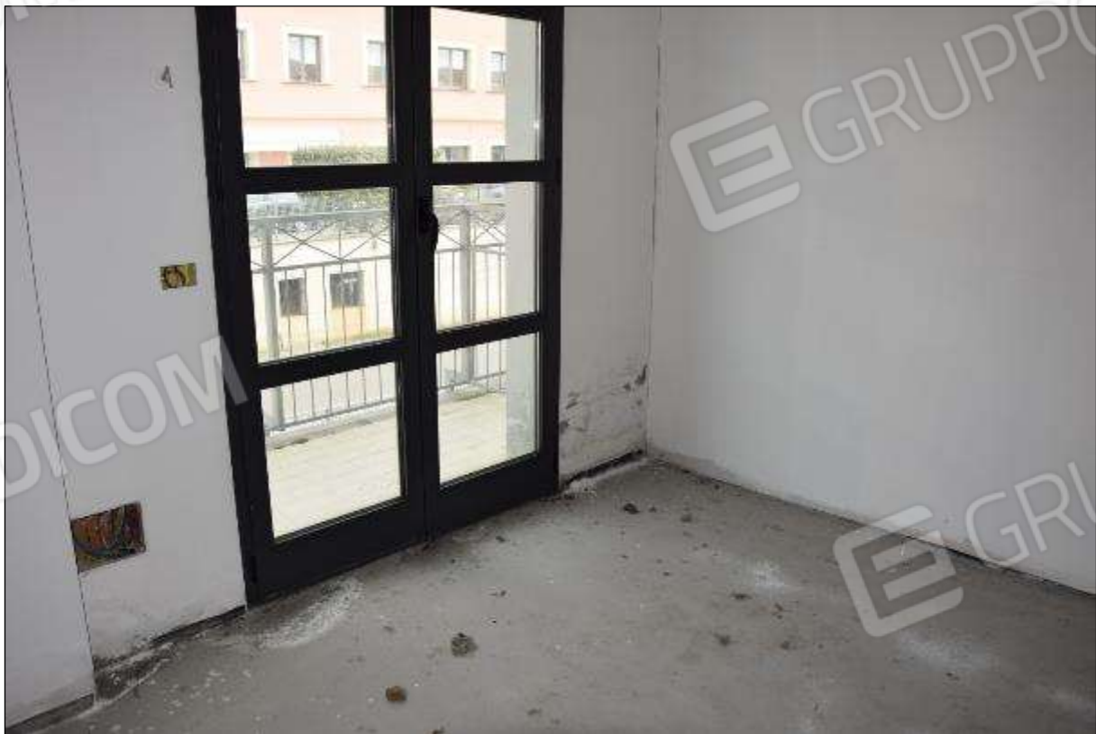
FOTO 90 – particolare - infiltrazioni d'acqua dalla terrazza
