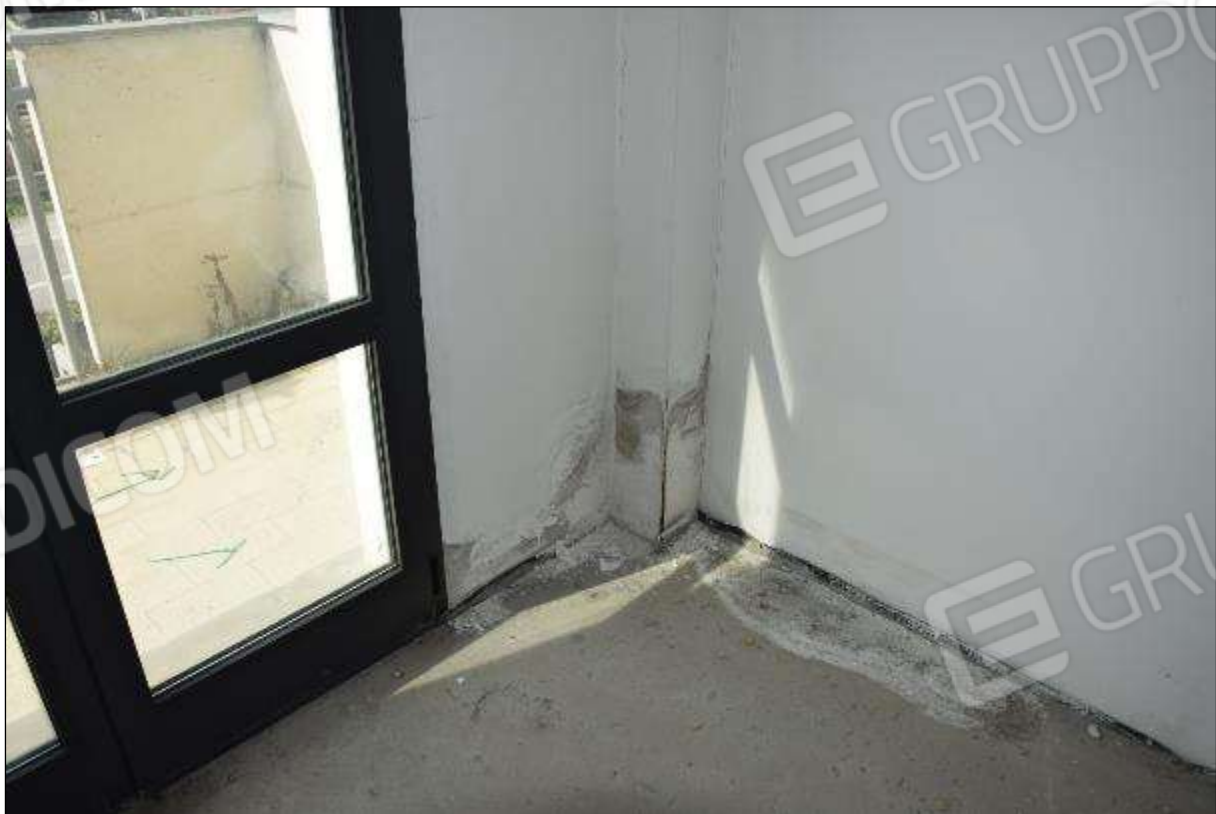
FOTO 12 – particolare - infiltrazioni d'acqua dalla terrazza
