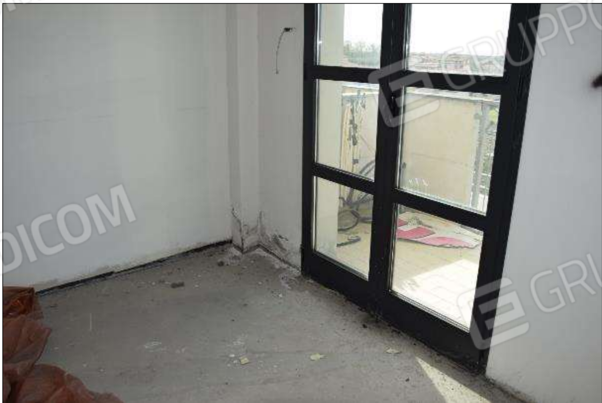
FOTO 44 - particolare - infiltrazioni d'acqua dalla terrazza
