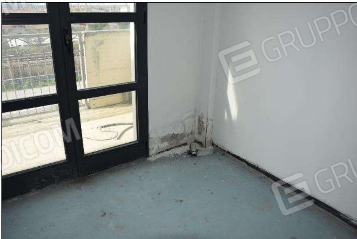
FOTO 24 – particolare - infiltrazioni d'acqua dalla terrazza
