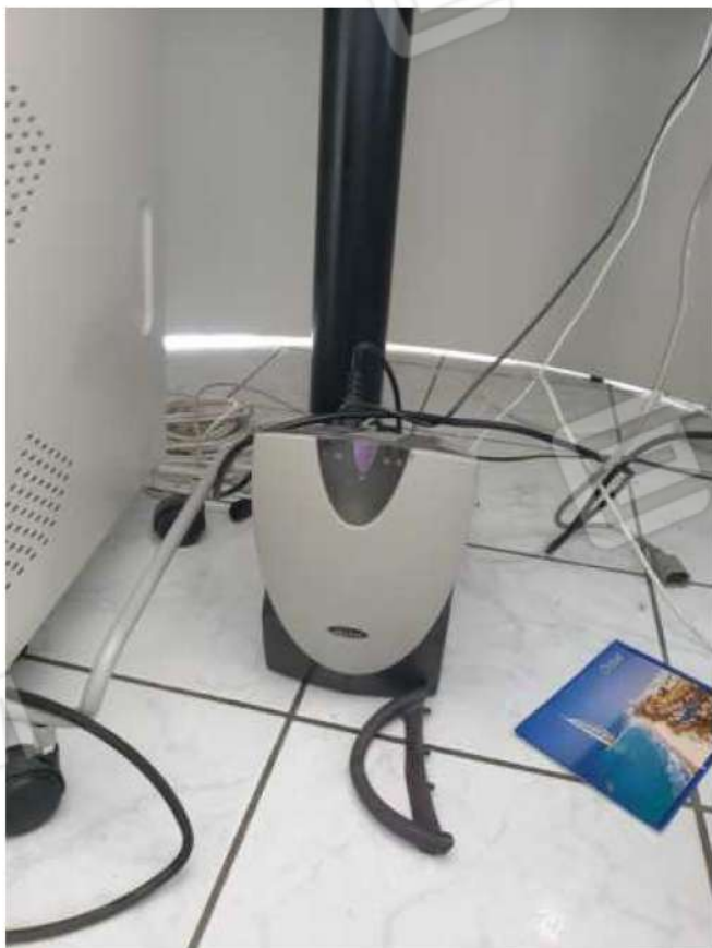
Foto 6. Ingresso, gruppo di continuità Belkin
