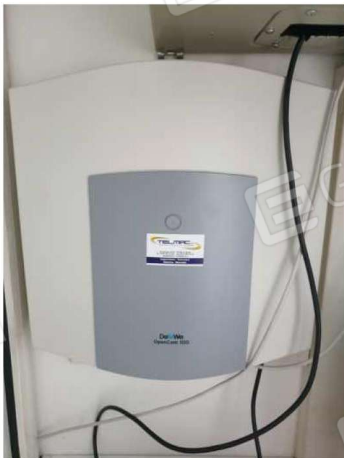
Foto 25. Ufficio 1, centralina telefonica marca Detewe Opencom 100
