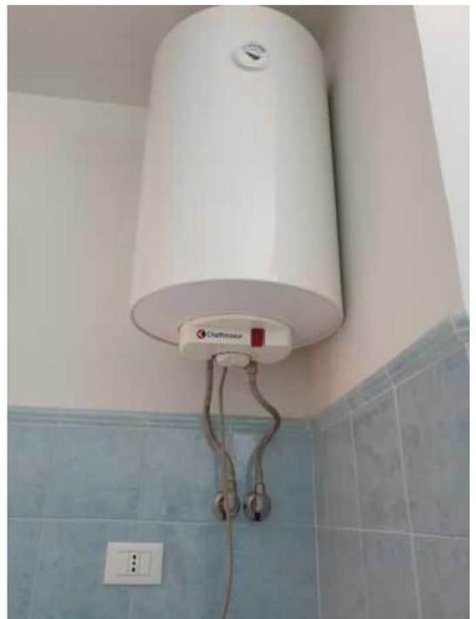
Foto 39. Bagno, boiler Chaffoteaux
