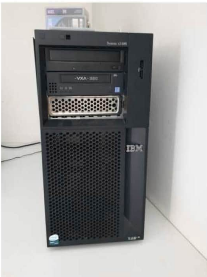
Foto 17. Ufficio 1, server di sistema
