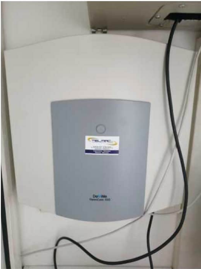
Foto 25. Ufficio 1, centralina telefonica marca Detewe Opencom 100
