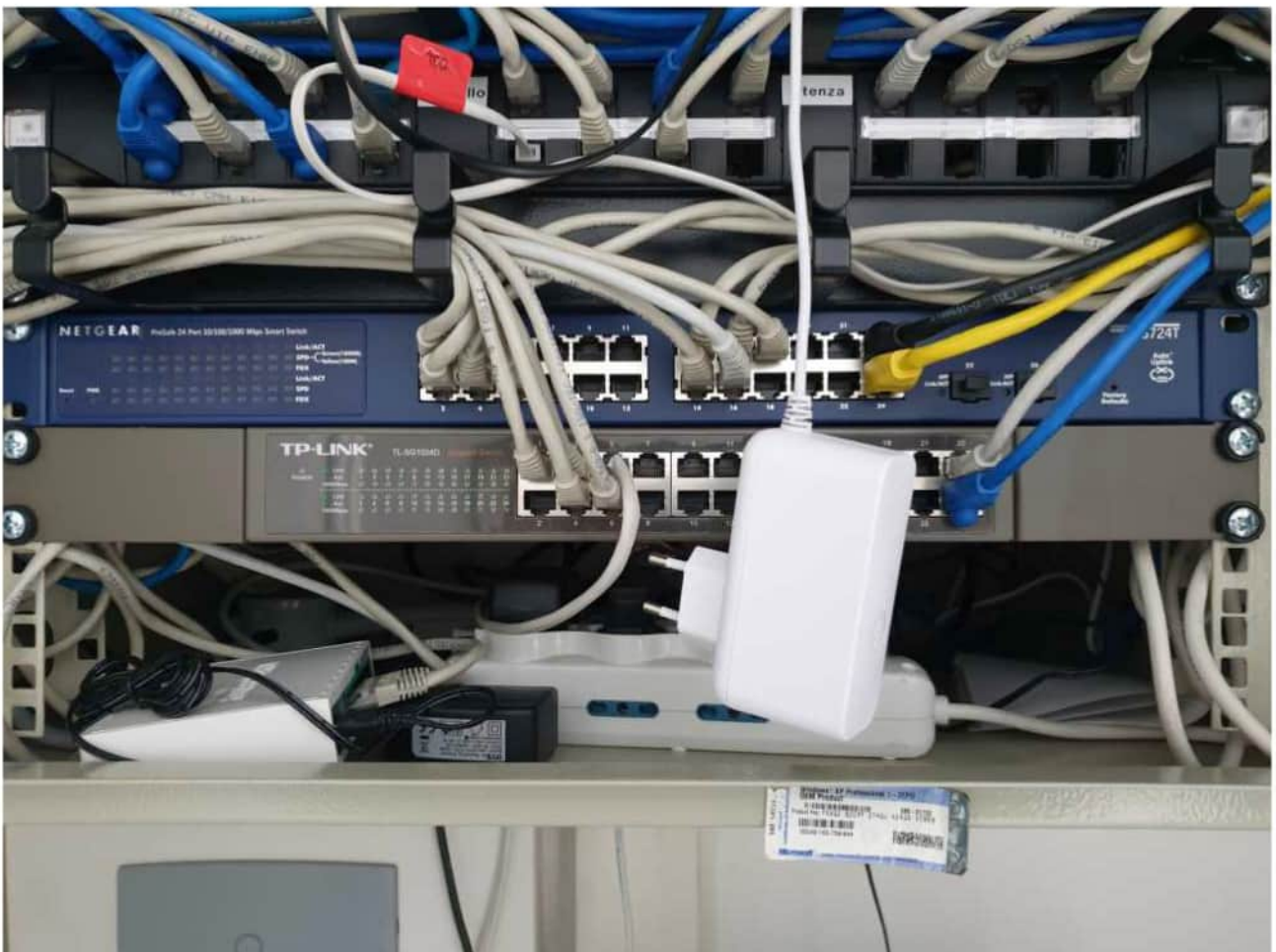
Foto 23 e 24. Ufficio 1, rastrelliera informatica (rack) composto da Fireworlds marca Netgear ProSafe 24 porte (Model GS724T), Switch marca TP-LINK modello TL-SG1024D, pannello telefonico e n° prese universali
