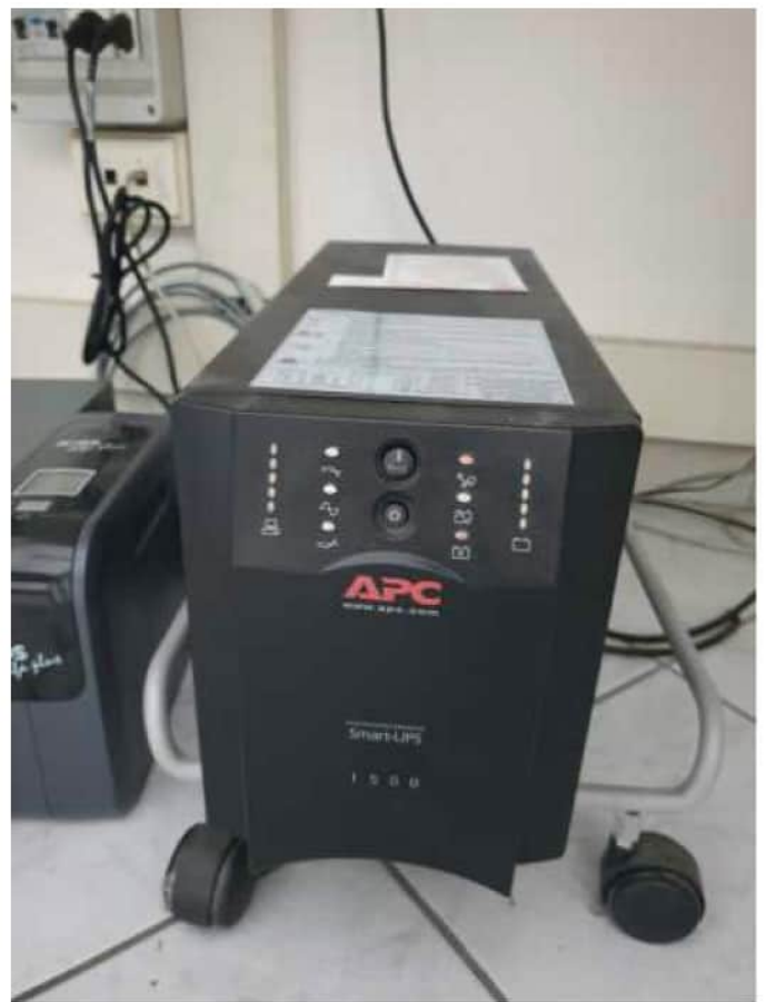
Foto 20. Ufficio 1, gruppo di continuità APC
