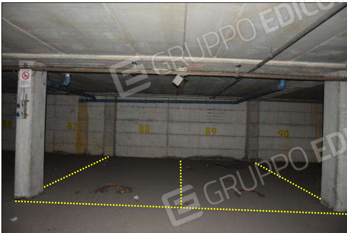
FOTO 5 – SUB 75 (POSTO 88) / SUB 76 (POSTO 89)
