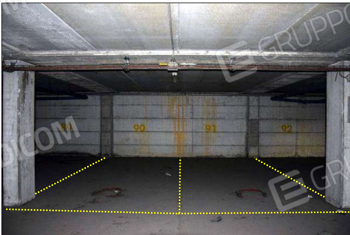
FOTO 6 – SUB 77 (POSTO 90) / SUB 78 (POSTO 91)
