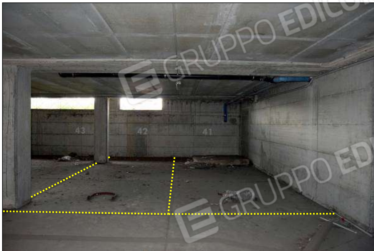
FOTO 1 – SUB 108 (POSTO 42) / SUB 109 (POSTO 41)
