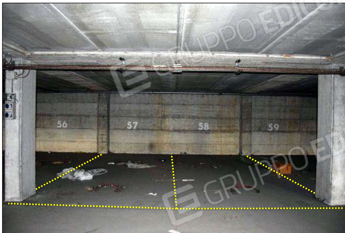
FOTO 1 – SUB 61 (POSTO 57) / SUB 62 (POSTO 58)
