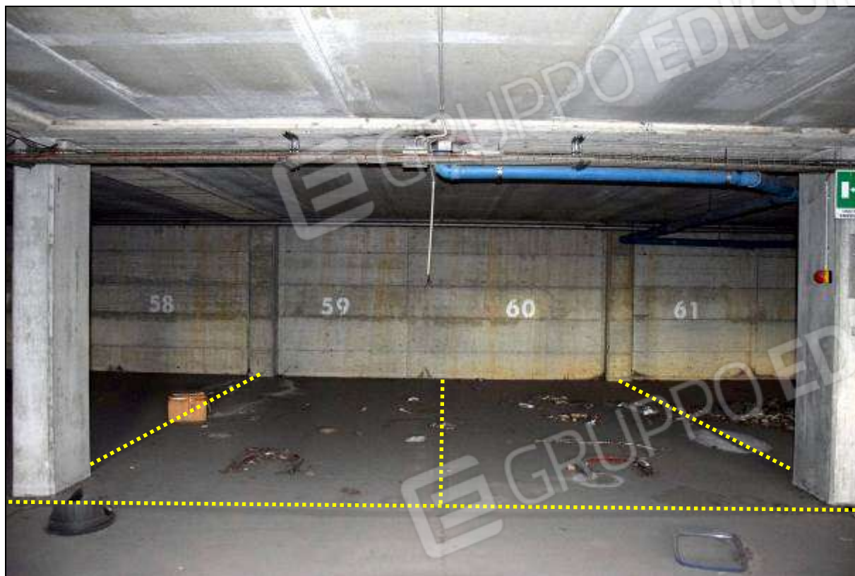
FOTO 1 – SUB 63 (POSTO 59) / SUB 64 (POSTO 60)
