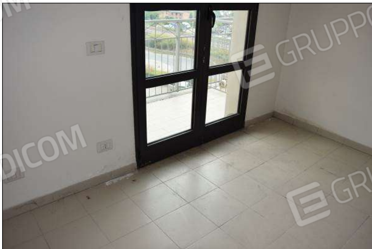
FOTO 25 – infiltrazioni di umidità
