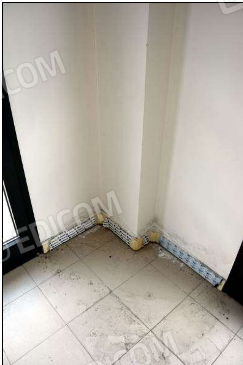
FOTO 11 – infiltrazioni di umidità
