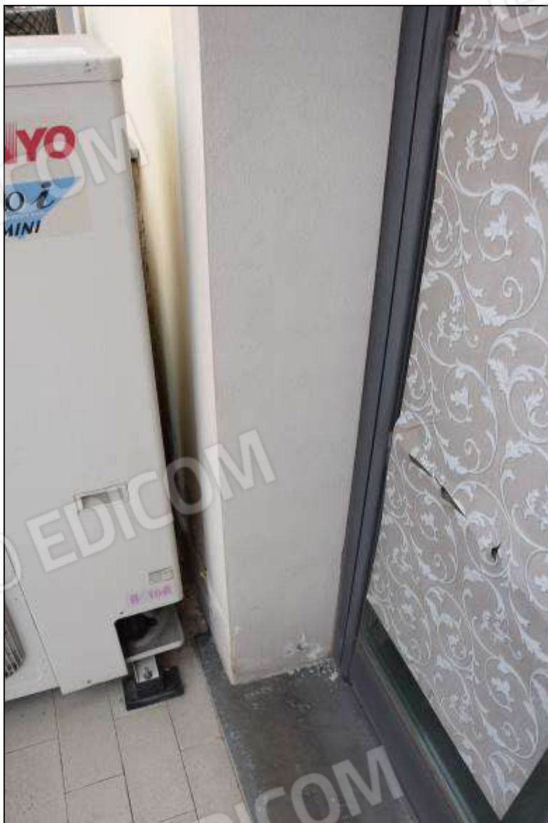
FOTO 11 – infiltrazione di umidità
