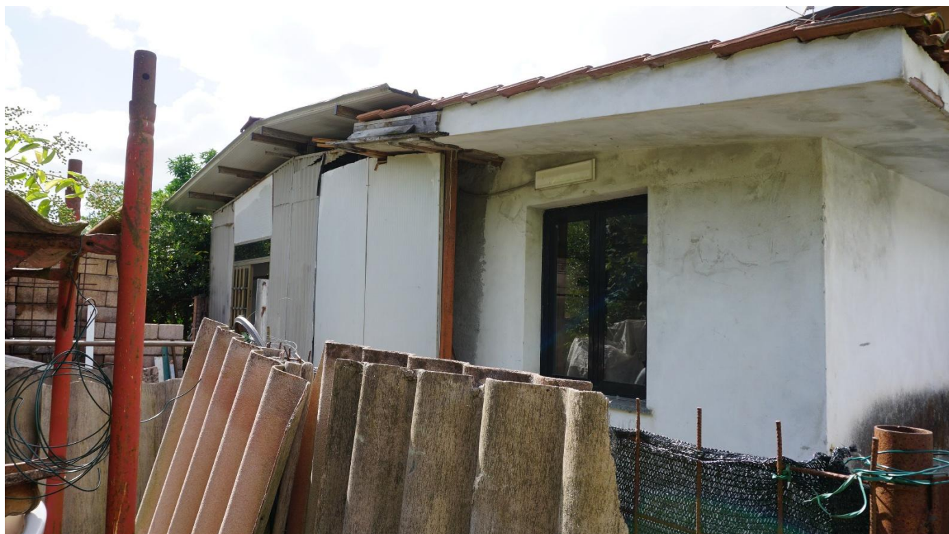
Figura 26 – manufatto esterno da rimuovere
