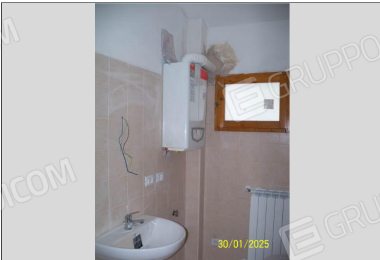
Vista interna: Caldaia murale posta nel bagno
