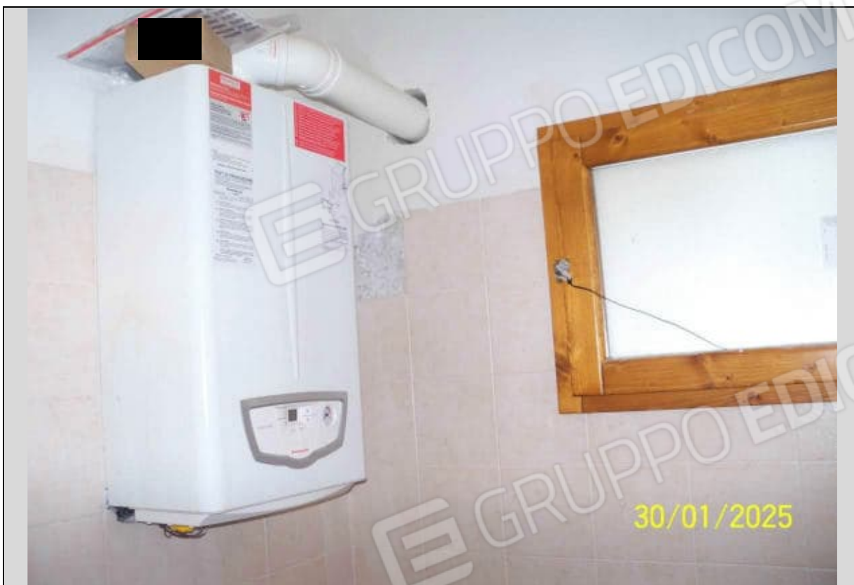
Vista Interna: Caldaia posta nel bagno
