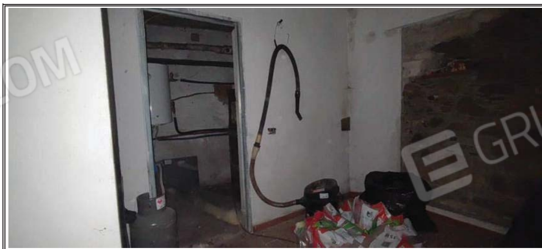
Foto n. 15 – Piano terra – Locale caldaia
