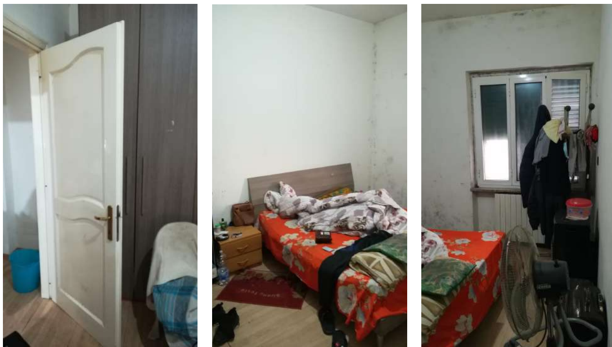
Foto n. 26-28: vista della camera 1. Problemi di muffa e condensa alle pareti.
