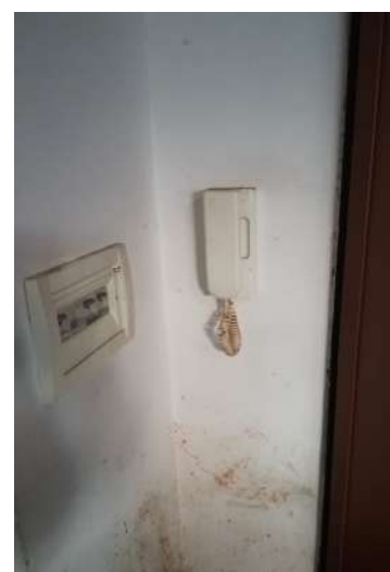
Foto n. 23: vista del quadro elettrico e del citofono/soggiorno.
