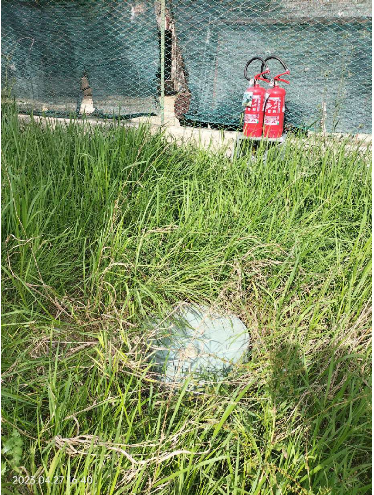
particolare bombolone GPL interrato nella corte esclusiva
