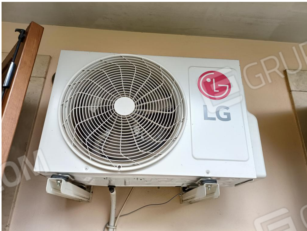
Fotogramma n. 18 Unità Esterna su Balcone Est
