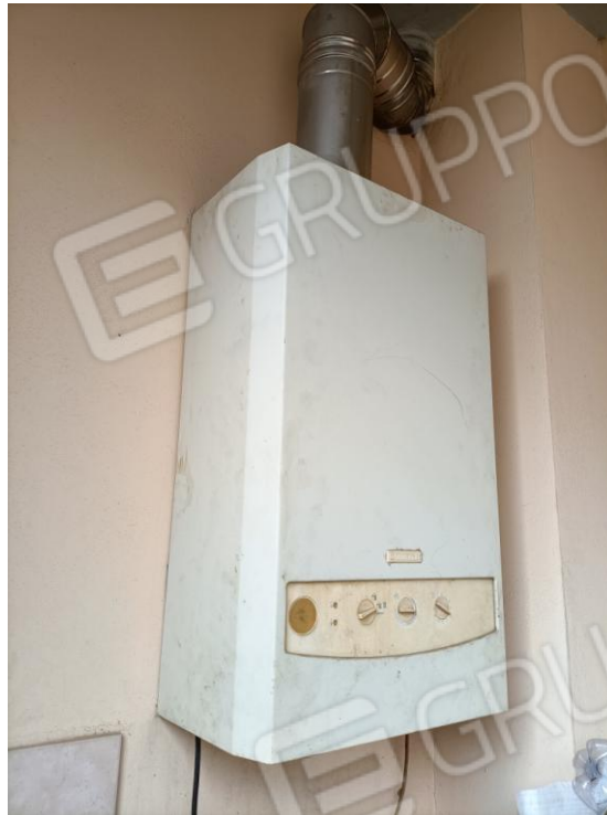
Fotogramma n. 17 Caldaia Esterna
