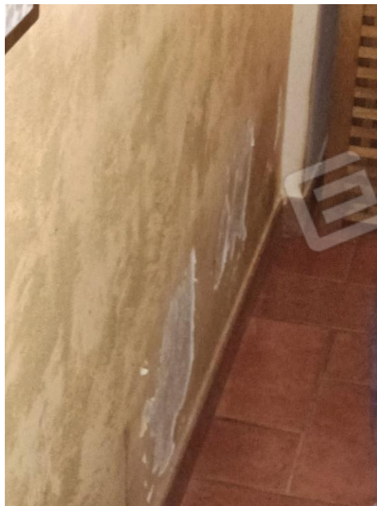
Fotogramma n. 26 Intonaco danneggiato nel Soggiorno
