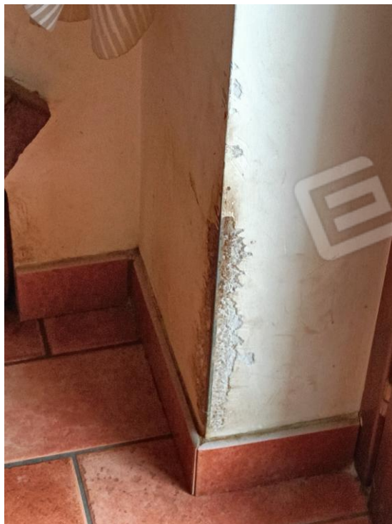
Fotogramma n. 28 Intonaco danneggiato nel Soggiorno
