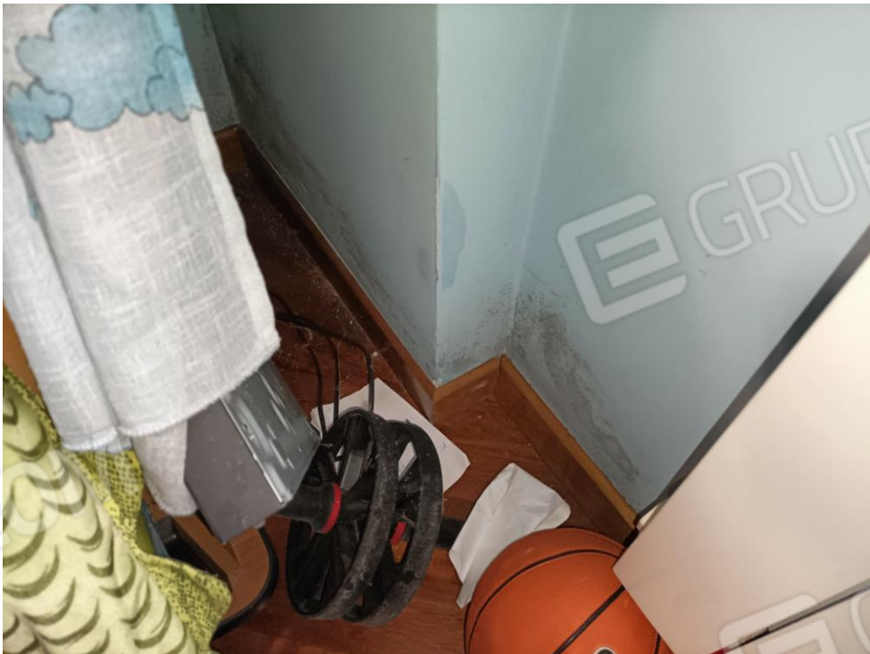
Fotogramma n. 30 Infiltrazioni Camera da Letto
