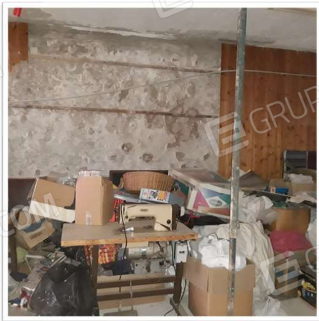
FOTO 14 – SEGNI DI UMIDITÀ DEGLI INTONACI
