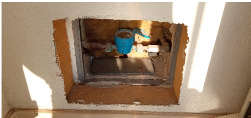
Contatore parziale acqua. Visibile il "cappotto" della parete
