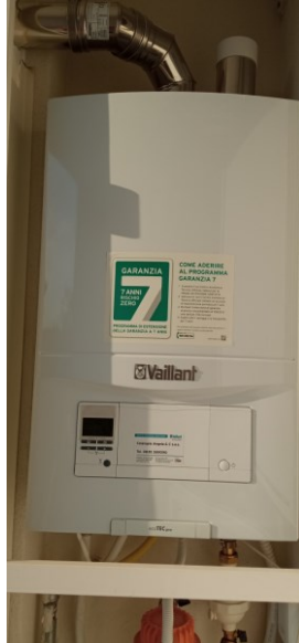
Caldaia impianto di climatizzazione invernale
