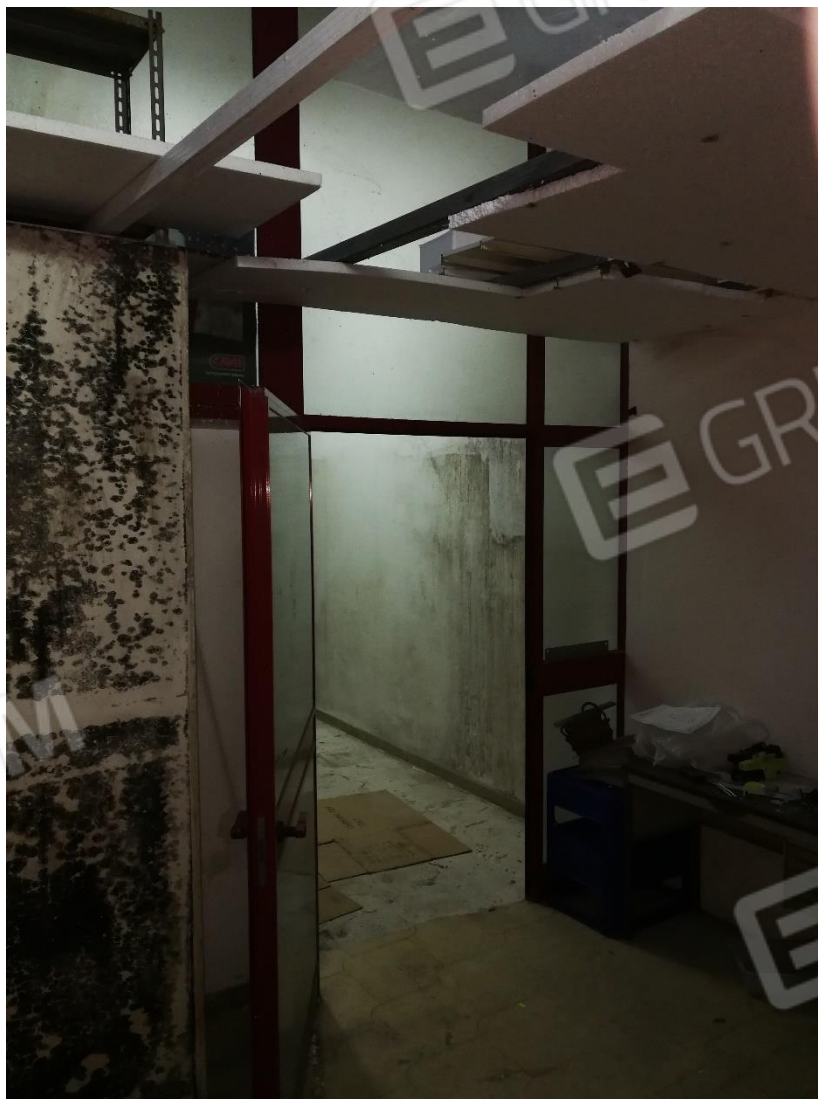
Ingresso dal vano scala al vano di separazione tra scala e cantina
