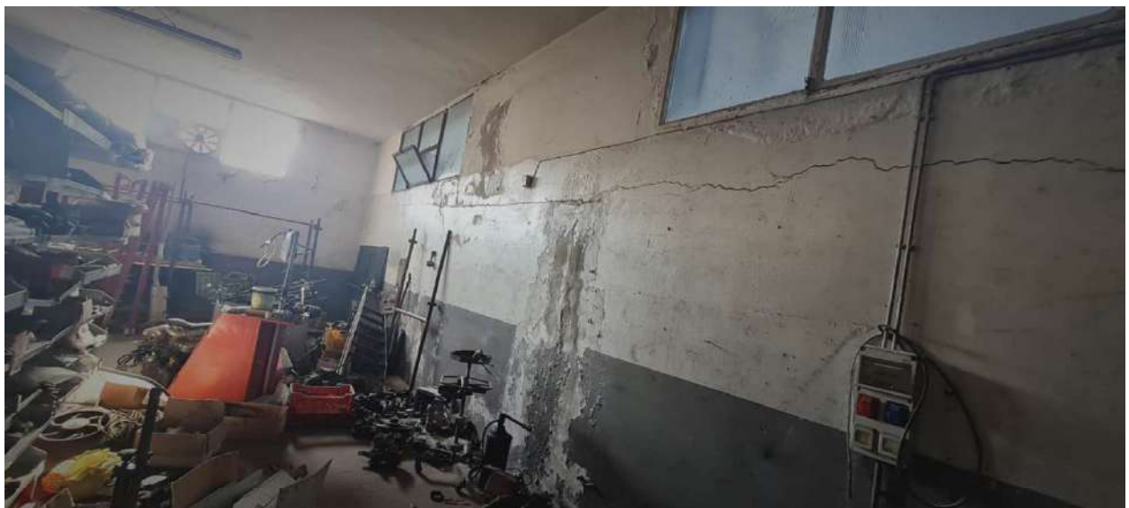
Figura 14 e 15 - Presenza di fenomeni di dissesto sulle murature perimetrali
