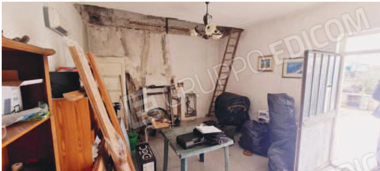
Figura 7 - vano a piano terra, è visibile il vano aperto nel solaio
