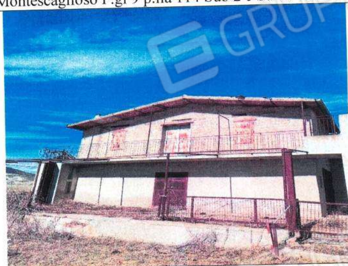
Comune di Montescaglioso F.gl 9 p.lla 114 Sub 2 e Sub 3 fabbricato collabente
