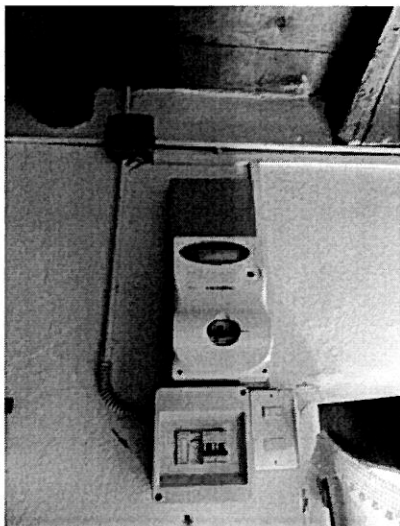
48 Contatore dell'energia elettrica posto al piano terra
