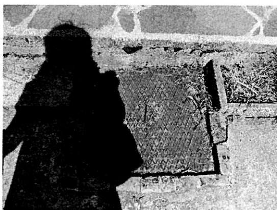
11 Chiusino posto davanti alla porta d'ingresso
