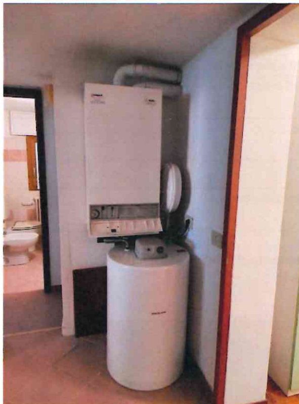
Corridoio e caldaia
