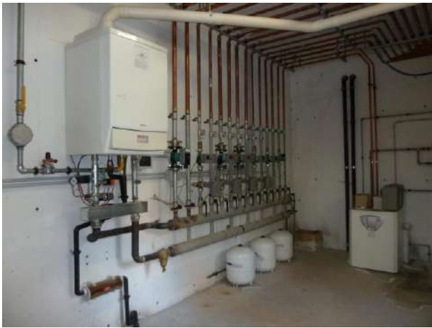
Piano sottostrada: centrale termica
