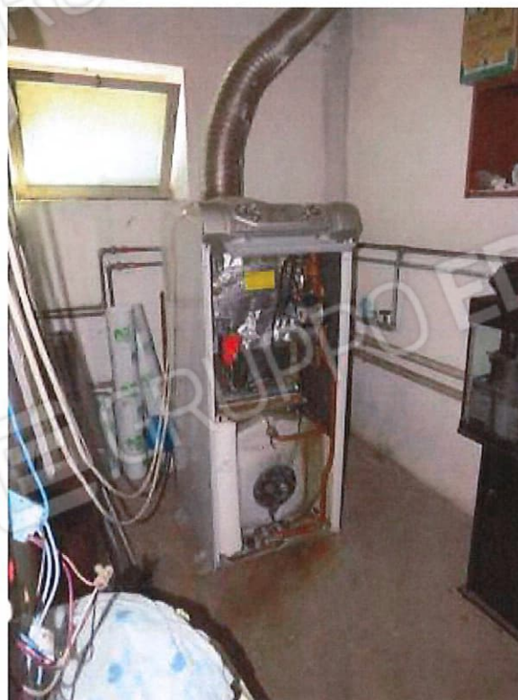
vista del locale tecnico in comune
