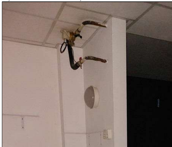
Figura 4: collegamento all'impianto condominiale ubicato nel locale uso privato e sotto il termostato
