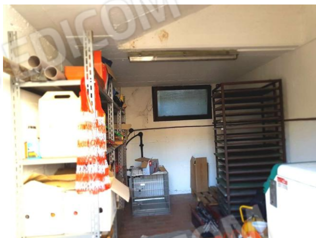
68 – Il locale centrale termica
