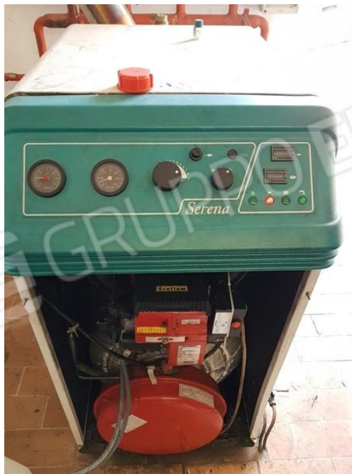
70 – Particolare del bruciatore
