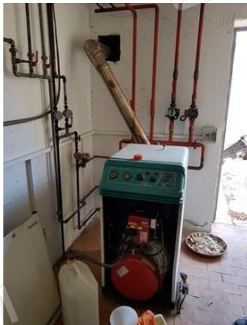
69 – il bruciatore all'interno del locale centrale termica
