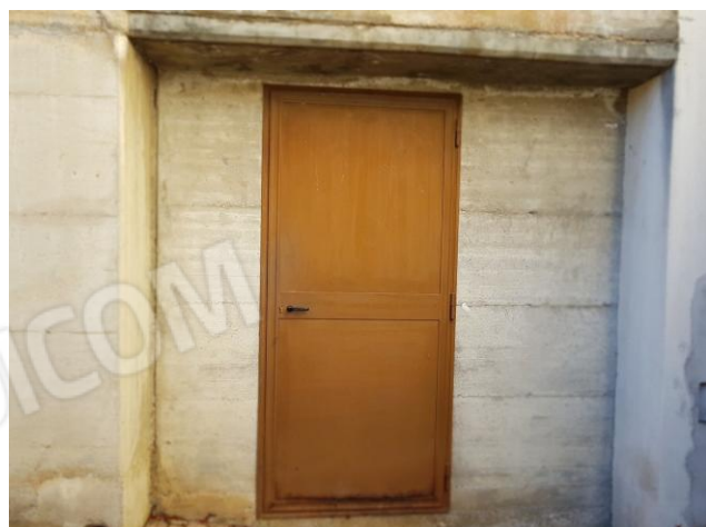
66 – Porta d'accesso al locale centrale termica
