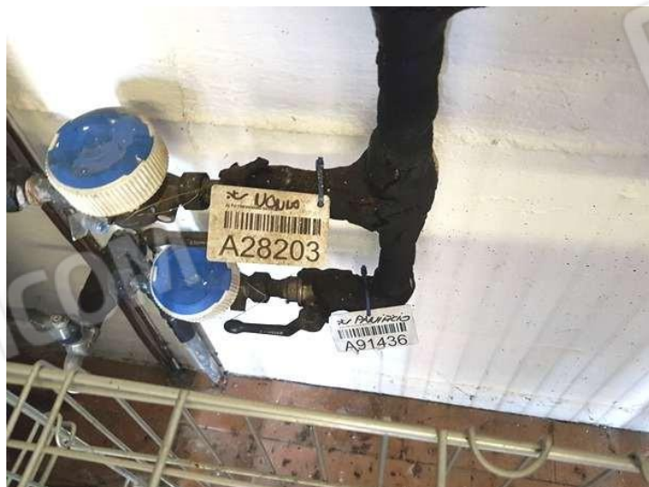
71 – Contatori nel locale centrale termica
