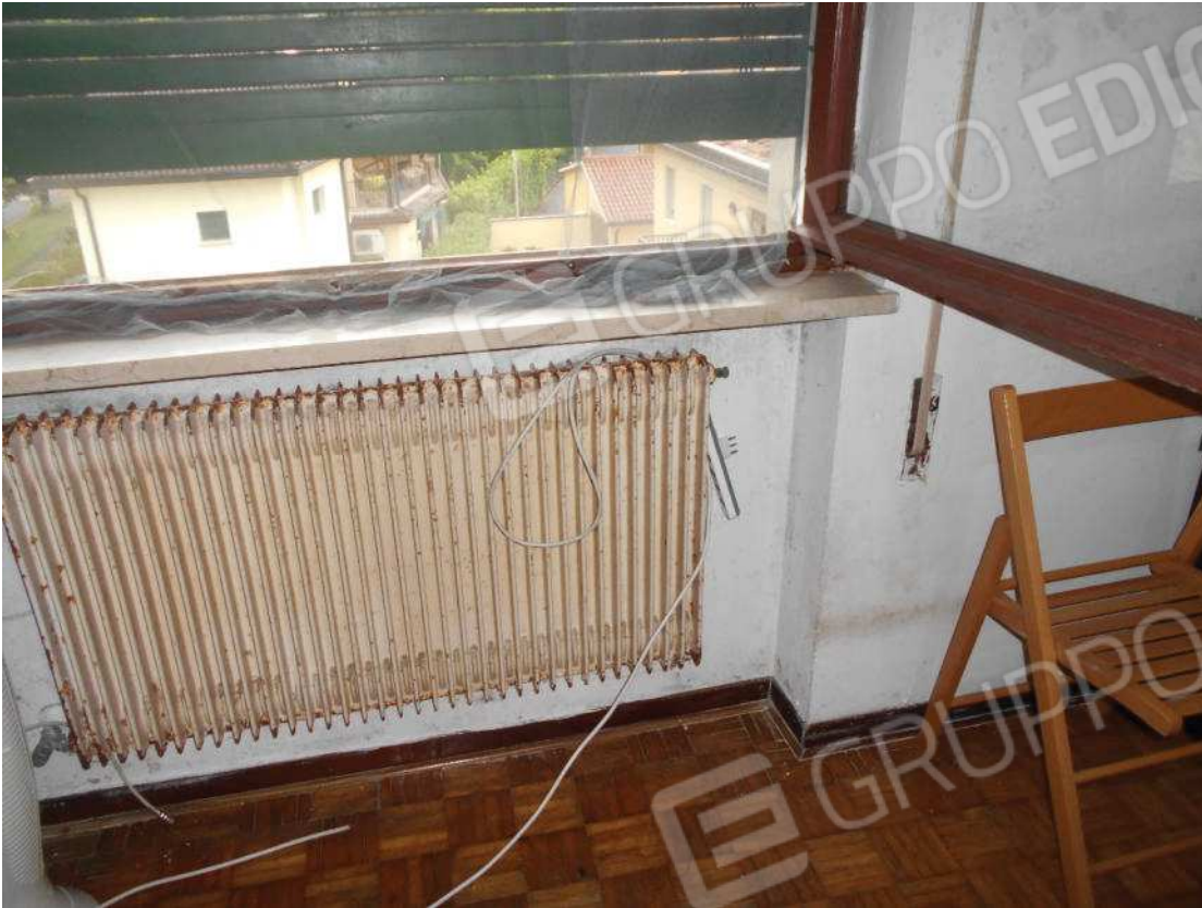
Foto 26: camera matrimoniale, particolare parete e termosifone
