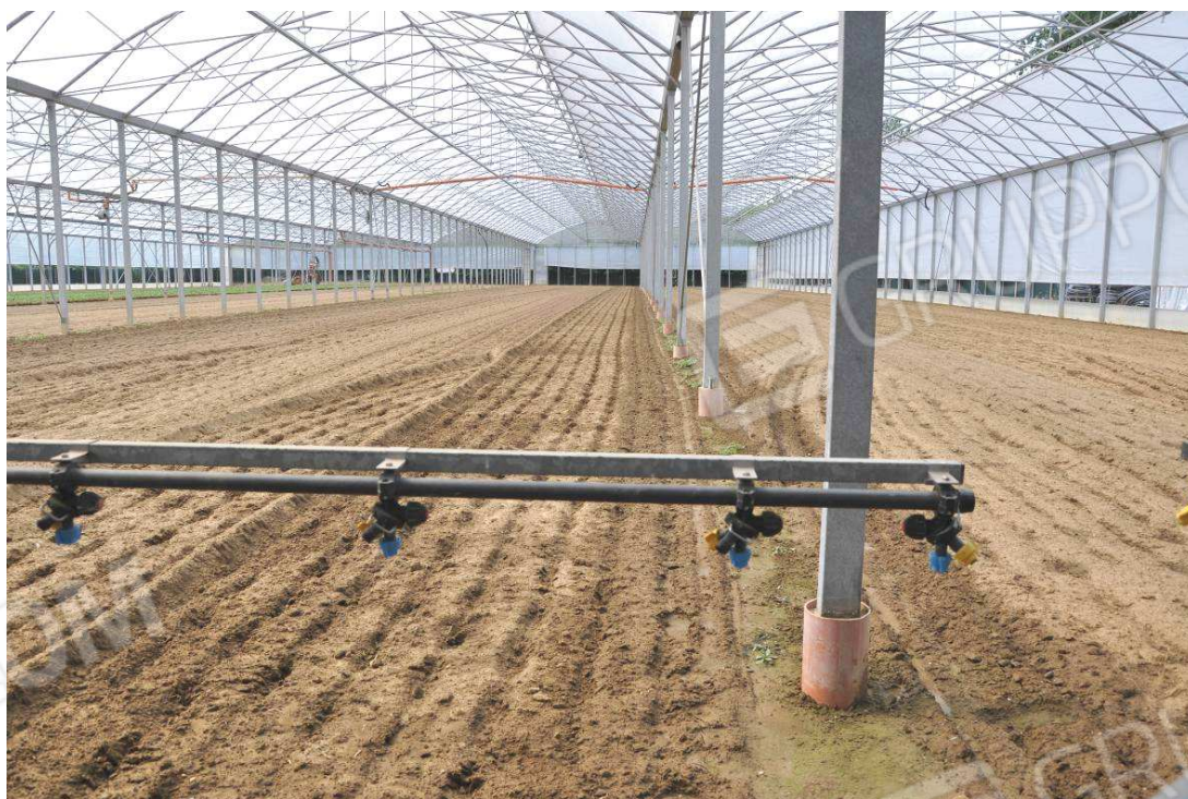
19. Interno della multiserra. In primo piano la barra per l'irrigazione.
