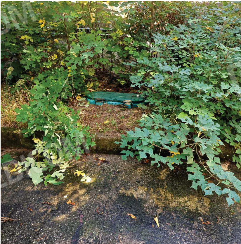
FOTO 21 – CISTERNA DEL GAS COMUNE SU AREA SUB 9 RECINTATA
