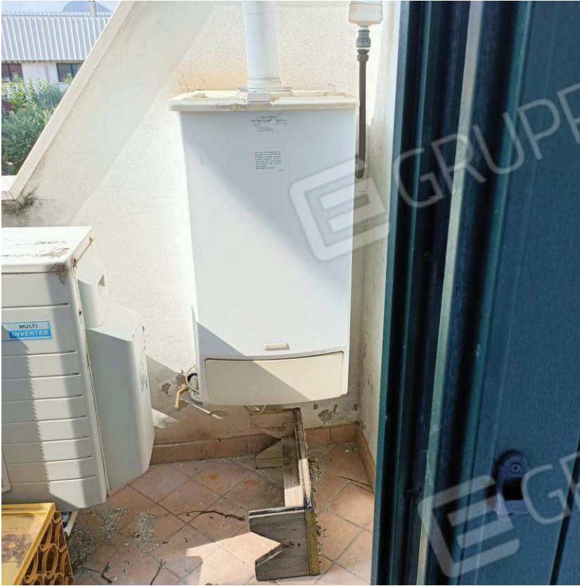
FOTO 21 – CALDAIA ESTERNA SUL TERRAZZO
