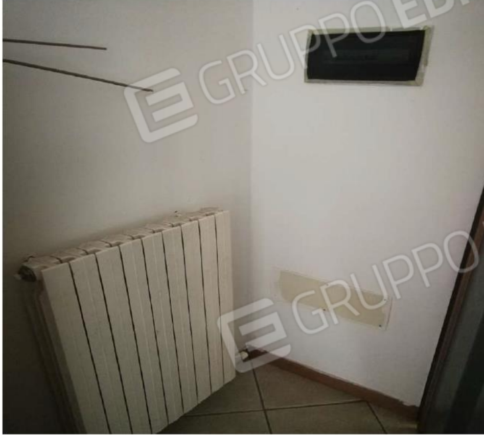
Fotografia n. 35 – Elemento riscaldante e quadro elettrico
