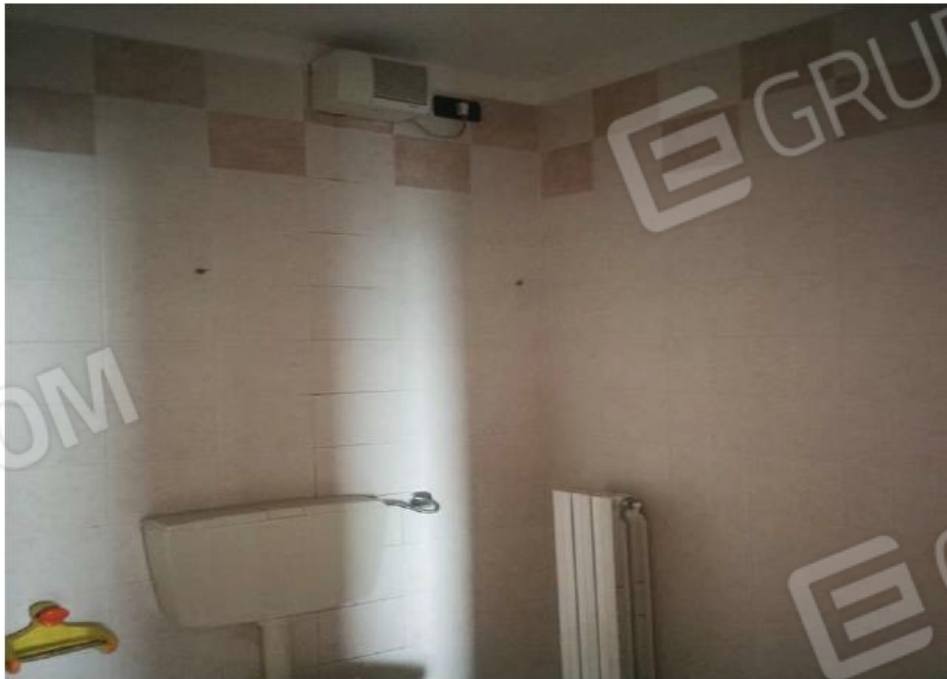
Fotografia n. 36 – Areatore a parete nel bagno
