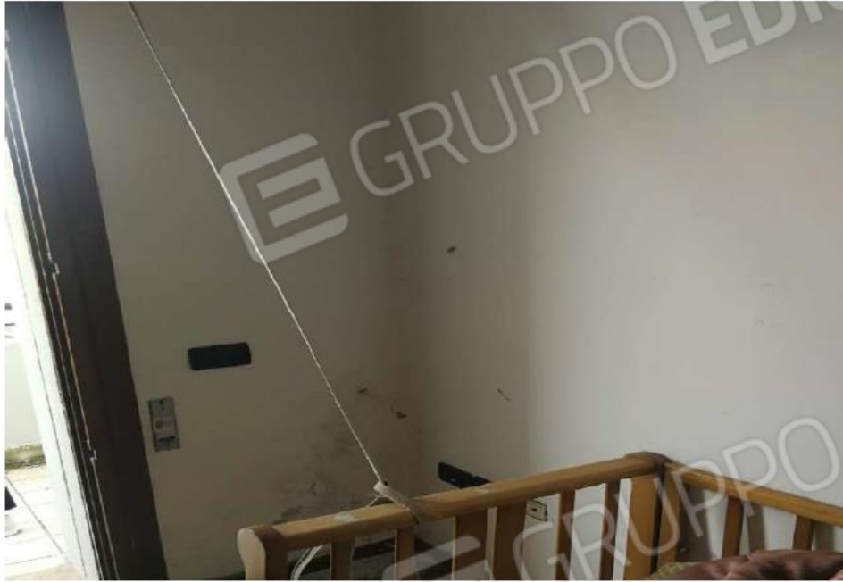
Fotografia n. 33 – Corda tapparelle rotta nella cameretta
