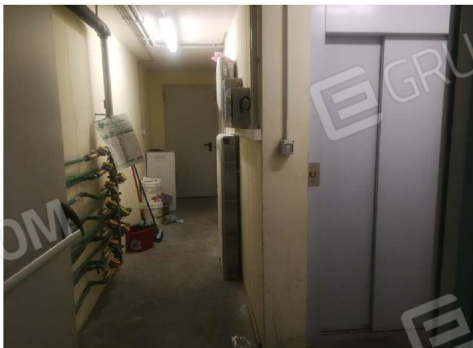
Fotografia n. 40 – Piano interrato: contatori gas e vano ascensore
