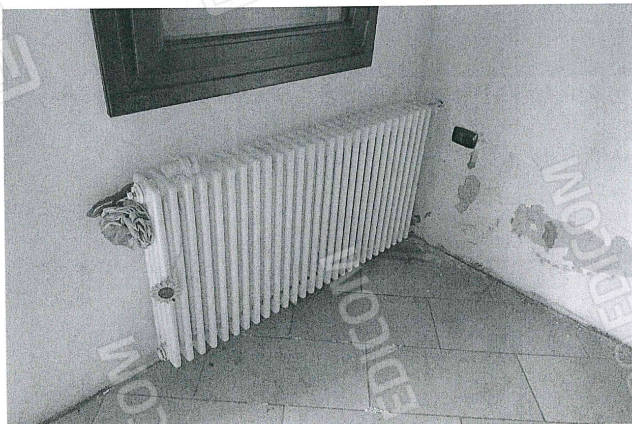
Foto 34 - Particolare impianto termoidraulico
