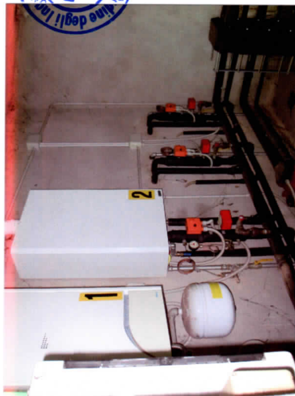
23 – Partic. d'interni: Ripostiglio 2 P.1° (Nuova C.T.) LOTTO 19
