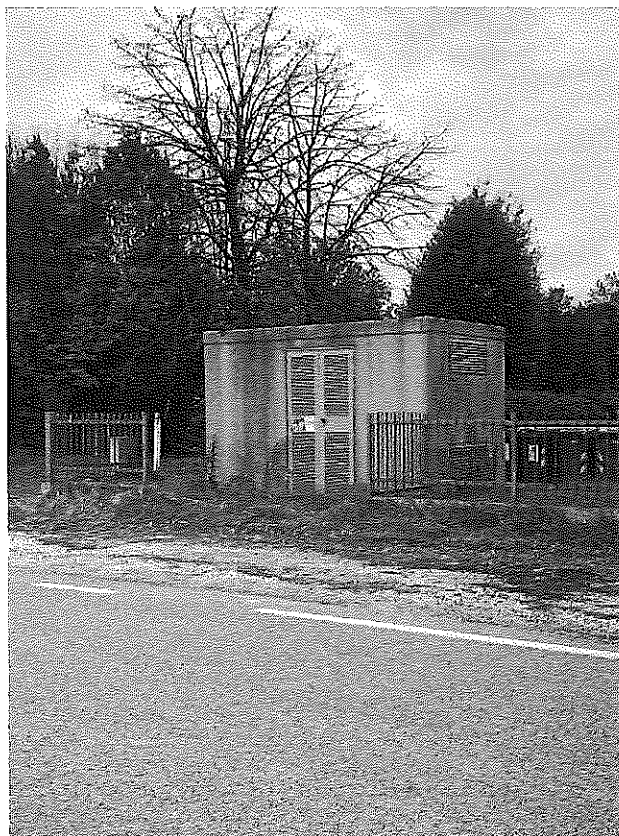
Figura 40 – Cabina elettrica su via Frassanedo
