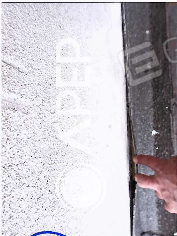
10 – Distacco verticale tipo di guaina impermeab. da muro P.1°
