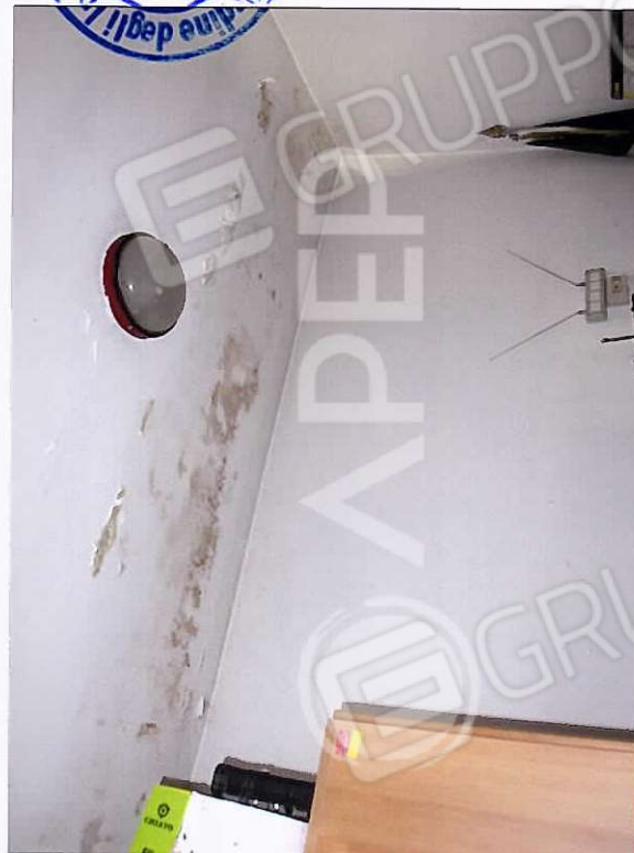
3 – Particolare di soffitto/muro - Zona Est Palco Teatro P.T.
