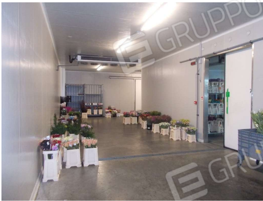
Foto 8- LOTTO 1- Reparto celle frigorifere - sub. 6
