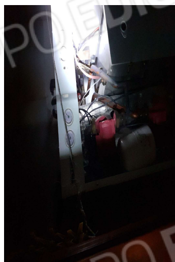
Foto n 8 caldaia inutilizzabile
