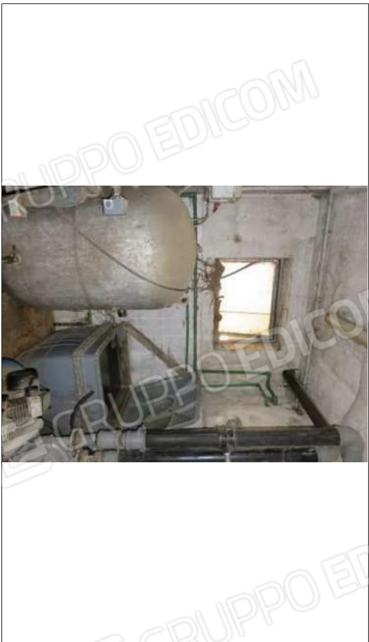
93 Vista di una sala macchine;
