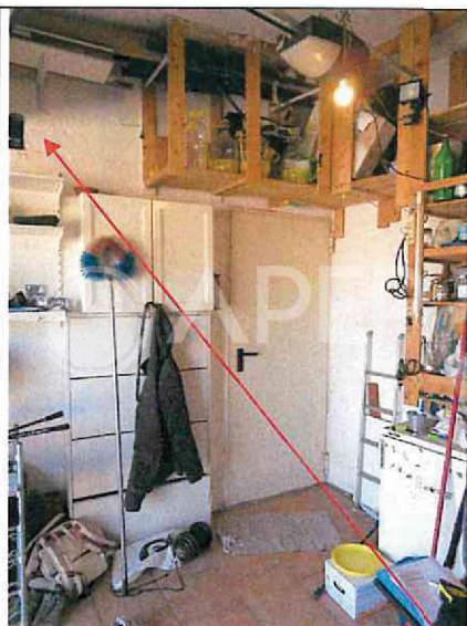
Foto n°48: Accesso dal garage all'ingresso P.T. all'unità abitativa – parete abusiva
