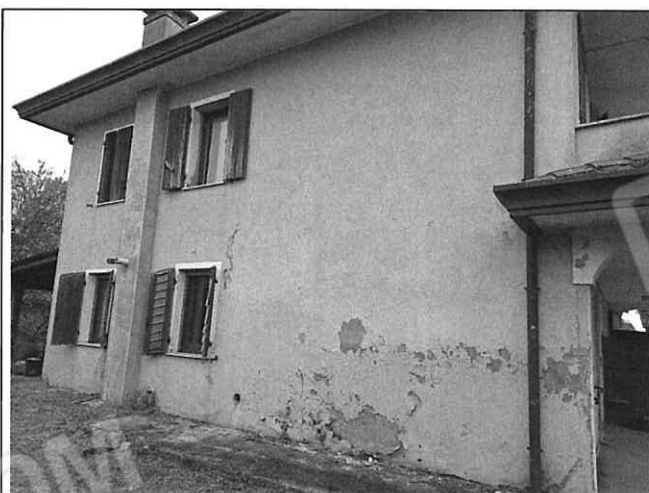
Foto n°8: Dettaglio del degrado del prospetto ovest
