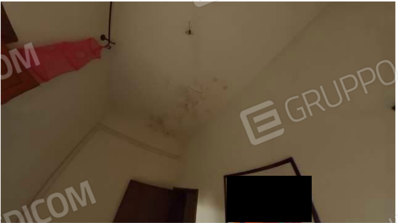
Figura 41 INTERNI PRIMO PIANO INFILTRAZIONE A SOFFITTO DELLA STANZA SINGOLA IN POSIZIONE CENTRALE
