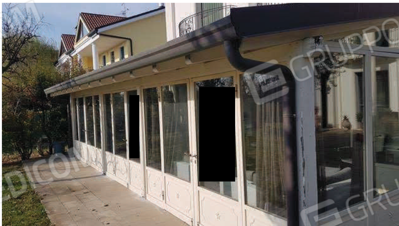
FOTO N. 08 - PARTICOLARE VERANDA NON AUTORIZZATA
