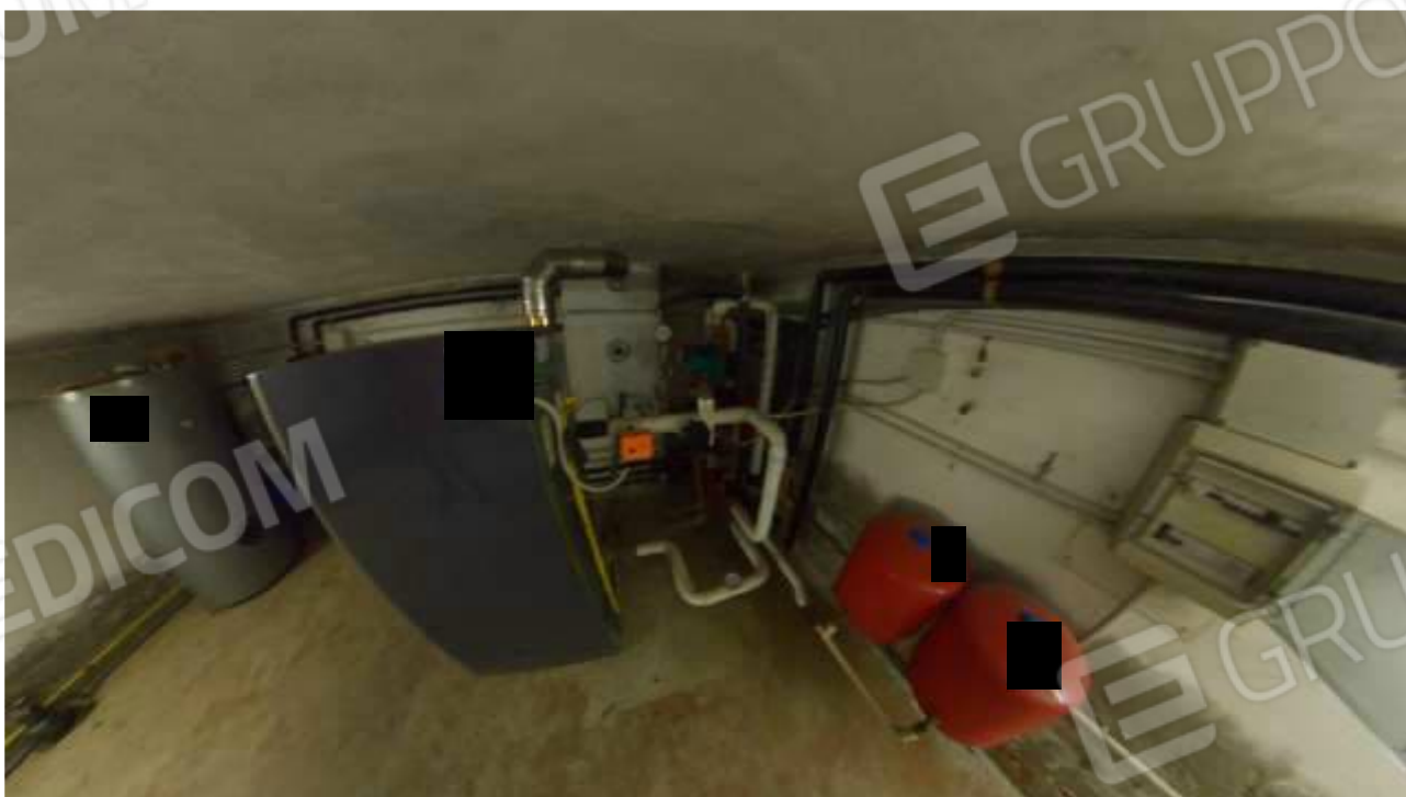
Figura 63 CENTRALE TERMICA AL PIANO SEMINTERRATO
