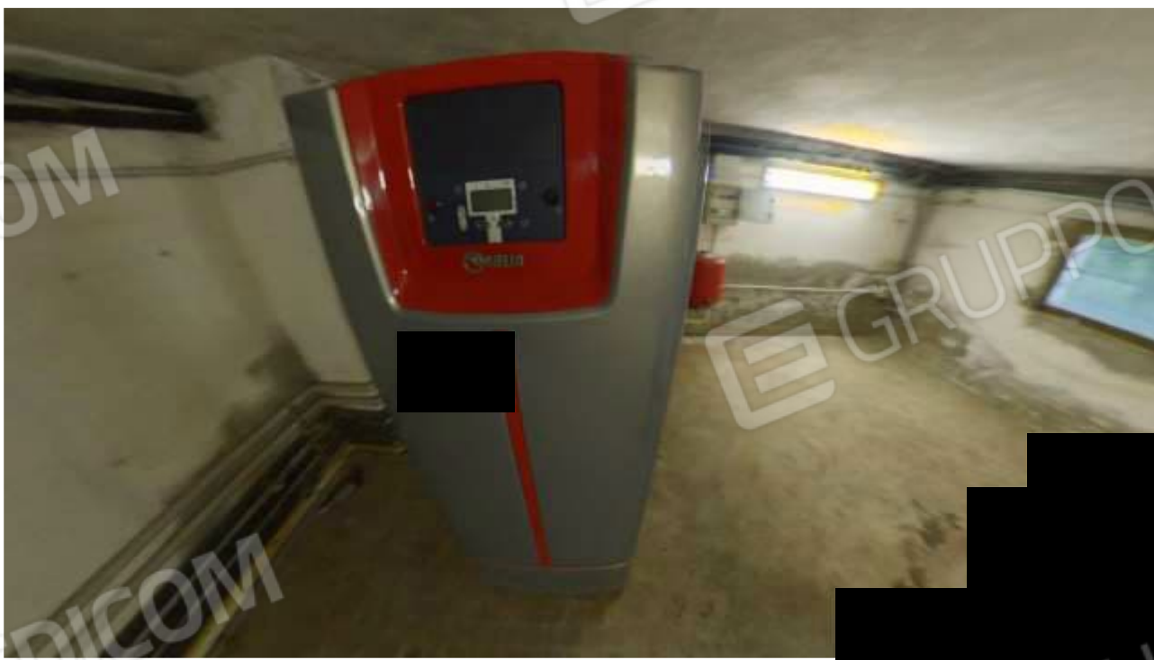
Figura 65 CENTRALE TERMICA AL PIANO SEMINTERRATO
