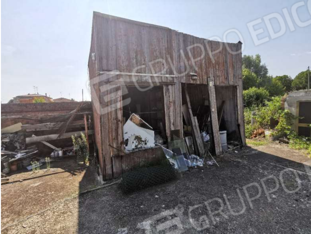
FOTOGRAFIA N.15 - particolare manufatto non autorizzato
